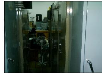
ELEMENTO PROVISIONAL DE VENTILACIÓN
