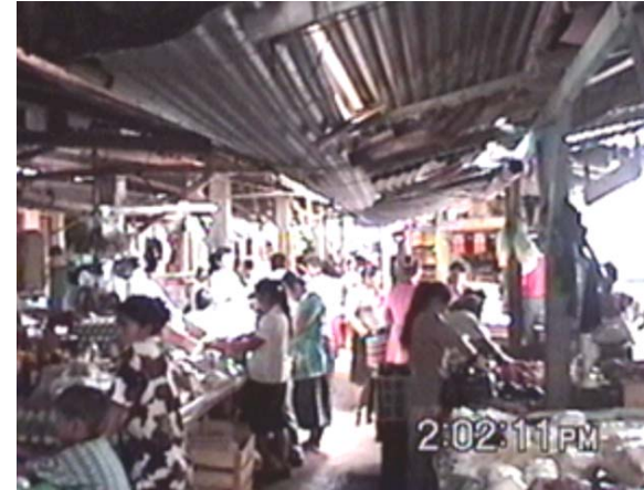
Cubiertas en mal estado, interior del mercado (Foto 38) Pajapita, San Marcos (mayo 2008) Fuente propia.
