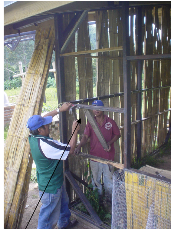
PERFORACION DE LAS COSTANERAS. ESTE PROCEDIMIENTO SE PUEDE REALIZAR CON BARRENO O CON UN CLAVO Y UN MARTILLO, EN ESTE CASO EL GOLPE DEBERA SER TIBADO.
