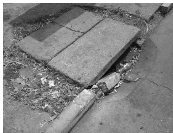
Fotografía no. 20: Drenaje pluvial
