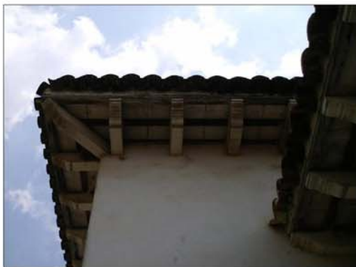
Fotografía No. 71 Las cubiertas en la parte exterior presentan daños en la madera causados por humedad y por la presencia de animales.
