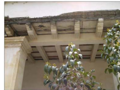
Fotografía No. 73 Desde el primer nivel se puede ver el grado alto de deterioro que presenta la terraza española en la fachada este.
