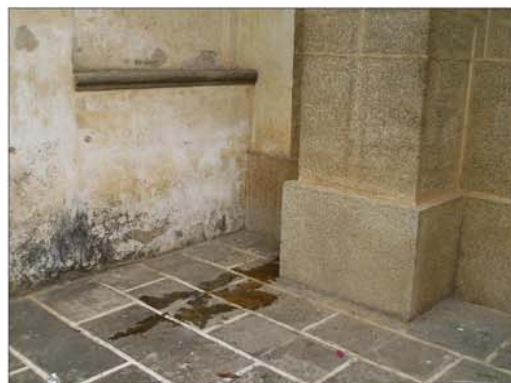
Fotografía No. 72 La fachada este y la norte sufren actos de vandalismo y suciedad, ya que lo utilizan como sanitario.
