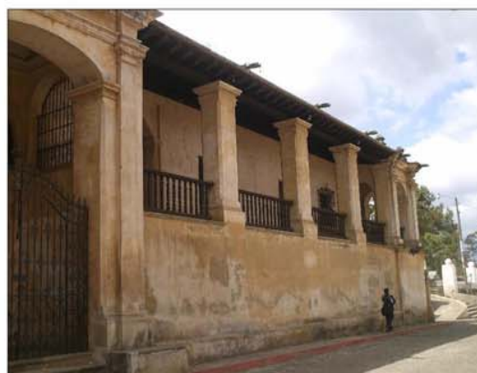
Fotografía No. 81 Esta parte de la fachada norte presenta intervenciones que han reparado grietas, pero es evidente las manchas por humedad del suelo.
