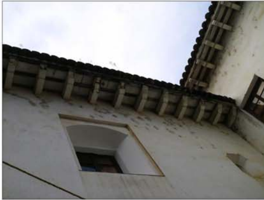
Fotografía No. 66 En la fachada sur se puede apreciar manchas por lluvia y por la presencia de animales como las palomas y las abejas.
