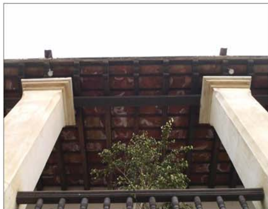
Fotografía No. 78 La terraza española de la fachada norte presenta humedad y desprendimiento de baldosas.
