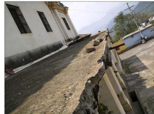
Fotografía No. 70 La terraza española de la fachada este está a punto de colapsar, ya que presenta fisuras, grietas y desprendimientos.
