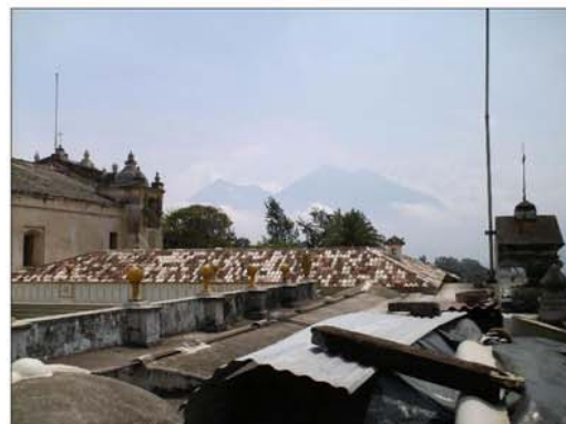
Fotografía No. 75 En la parte sin cubierta del segundo nivel es claro ver humedad en los muros y techos, además se han dejado restos de la madera que quitaron para reparar el techo del museo.
