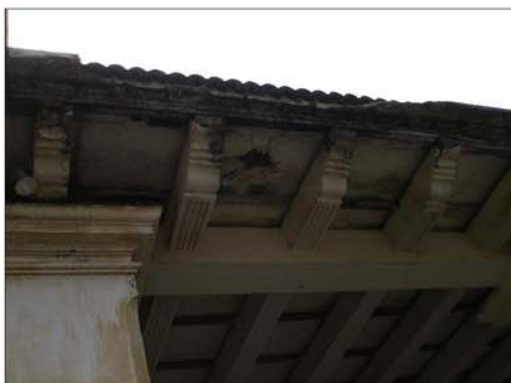
Fotografía No. 74 Aquí también se ven los desprendimientos en la terraza española.
