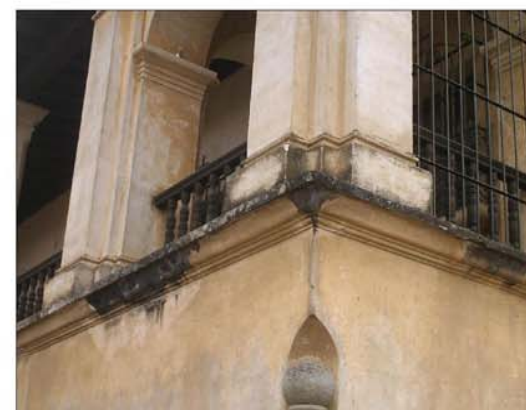
Fotografía No. 82 Manchas por humedad, hay que darle mantenimiento a toda la fachada.
