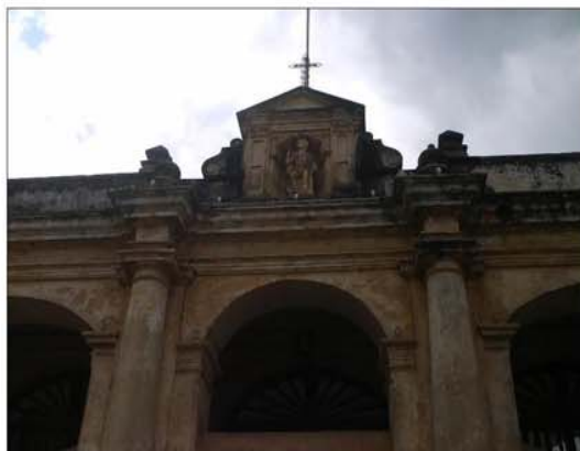
Fotografía No. 80 Igual que la fotografía anterior, manchas por hongos y oxidación.
