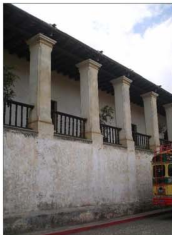
Fotografía No. 77 La fachada norte es afectada directamente por los buses lo cual le causa manchas por dióxido de carbono aparte de la humedad.
