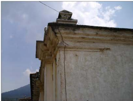
Fotografía No. 69 Los muros exteriores de la parte este del segundo nivel, presentan manchas causadas por humedad, y tiene como consecuencia oxidación.
