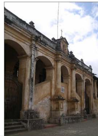
Fotografía No. 79 Aquí hay presencia de humedad, oxidación y hongos por lluvias y solemiento.
