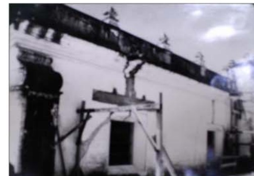
Fotografía No. 63 Capilla del Convento. Consolidación de muros exteriores en todo el derredor. Nótese que están dañados en partes críticas como: dinteles, cornisas y cenefas.
