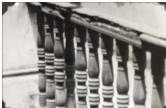
Fotografía No. 62 Pasamanos de la loggia en malas condiciones. Por estar expuestas a las inclemencias del tiempo.
