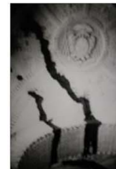
Fotografía No. 63 Nótese interior el trabajo de Obras Públicas. Consolidación de bóvedas. Falló terminar estuco en bóvedas.
