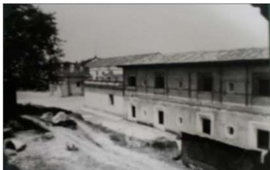
Fotografía No. 58 Fachada sur del Palacio. Falta completar repello del segundo nivel así como los trabajos exteriores aledaños.
