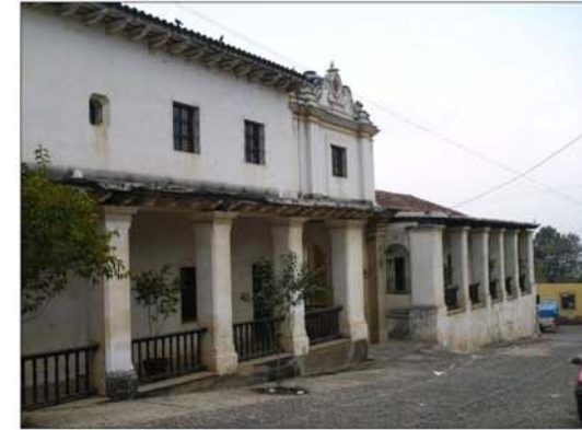
Fotografía No. 68 La fachada este presenta tanto en los muros como en las columnas manchas causadas por la humedad, lo cual indica oxidación y hongos, además hay desprendimientos en la terraza española.
