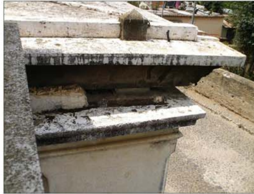
Fotografía No. 67 En las columnas de la fachada este tiene manchas por lluvia, presencia de hongos y es nido de palomas.
