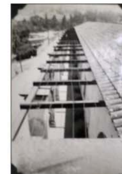
Fotografía No. 60 Falta completar cubierta loggia hasta la fachada norte. Consolidar columnas y capiteles de la loggia.
