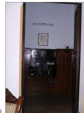
Fotografía No. 76 Aquí podemos ver una alteración por cambio de acabado en los muros y en el piso, ya que se han utilizado materiales modernos como el piso cerámico.
