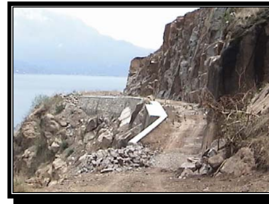
FOTOGRAFÍA No.45 ESTADO FÍSICO DEL TRAMO CARRETERO TZANIMUL
