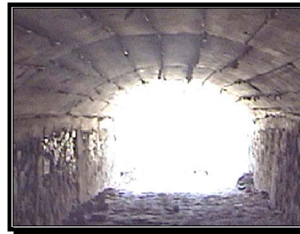
FOTOGRAFÍA No.52 BÓVEDA DE CAPTACIÓN DE AGUA PLUVIAL
