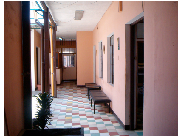
Algunos de los muros interiores que tienen contacto con áreas abiertas o a la intemperie, muestran una decoloración causada por la esporádica exposición a los rayos solares y un ligero exceso de humedad causada por las lluvias.
