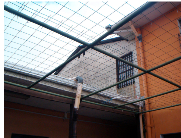
Las instalaciones de agua pluvial están expuestas (vistas), no están integradas al edificio y están en mal estado.
