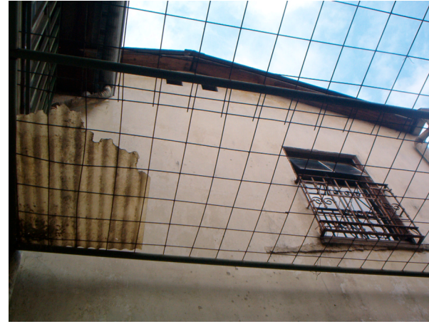
En las áreas y agregados al inmueble, no se conserva un estilo ni topología definido de los materiales, además de que los elementos instalados para la seguridad en el inmueble no se integran a la tipología y estilo del inmueble.
