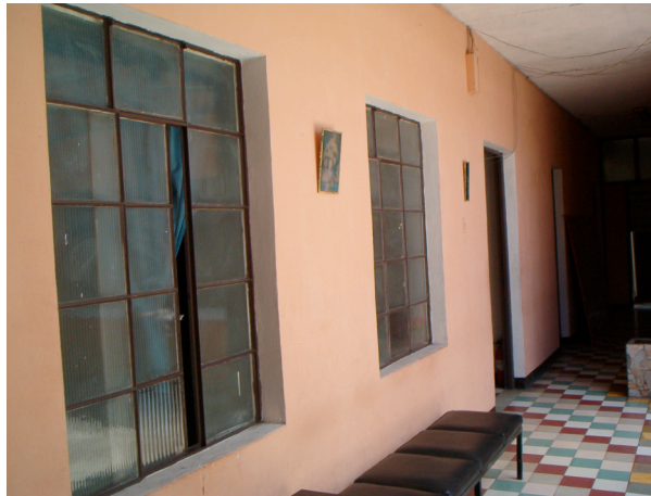
Las puertas y ventanas interiores se encuentran (la mayoría) buen estado, debido a su reciente fabricación y el material con el cual fueron elaboradas
