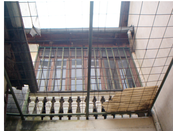
Se han colocado elementos sobre puestos que bloquean la visual y no se integran al edificio. Es necesario conservar las estructuras que sirvan para resguardar el interior del edificio pero es necesario integrarlos.
