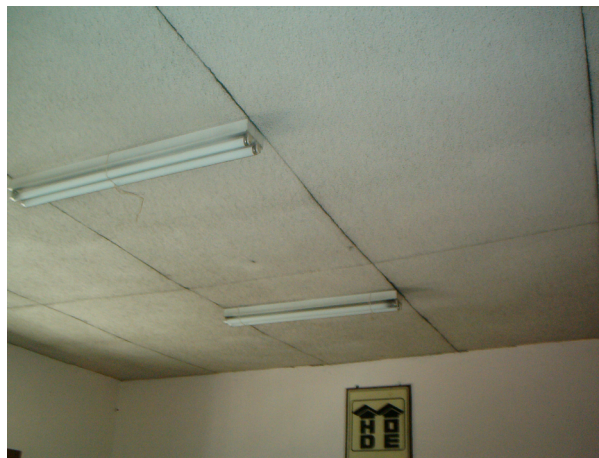
Los techos cubiertos en la parte interior por cielo suspendido, se encuentran en mal estado debido al agrietamiento de las juntas y al corto tiempo de vida propio de los materiales
