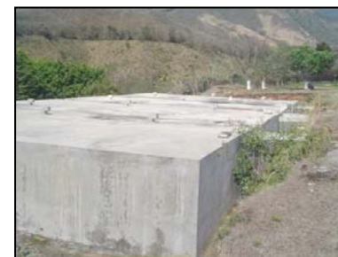
Tanques de Almacenamiento
