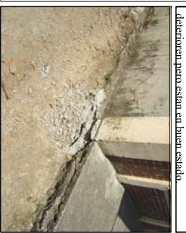
Foto No. 5 y 6: El predio cuenta con Cimentacion semi descubiertos, la cada del agua pluvial hace que al dar golpe en el suelo hace que estos se deterioran para estan en buen estado.
