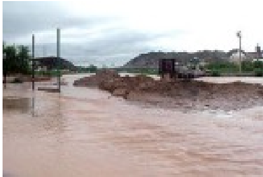
(Foto. No. 11 Colapso del puente Shinshin Zacapa, Guatemala).
