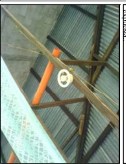
Foto No. 5 y 6: El prelo cuenta con luz eléctrica en las fotos podemos observar el contador que distribuye la energía, y también se observa la instalación expansiva.
