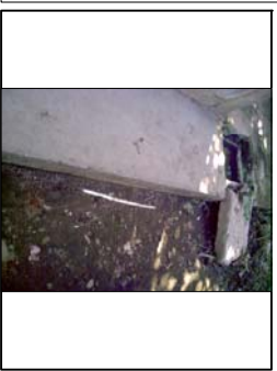
Foto No.5 y 6: El prelio cuentan con una pila externa para uso de los usuarios del plantel, se puede apreciar el sistema hidraulico del edificio el cual es de forma oculta.
