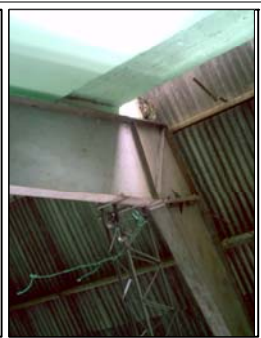
Foto No. 5 y 6: Se puede observar la estructura del techo el cual utiliza tendales de metal y el buen estado de la cubierta de techo de lamina metálica.
