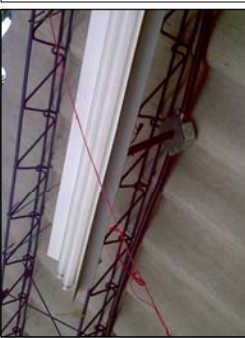
Foto No. 5 y 6: La estructura del techo es joist con cubriera de lamina de fibrocemento, las instalaciones electricas son expuestas y si funcionan.
