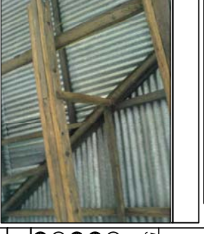
Foto No. 4: El edificio cuenta con un sistema estructural del techo tipo tendales y tiras de madera, y una cubierta de lamina metálica.
