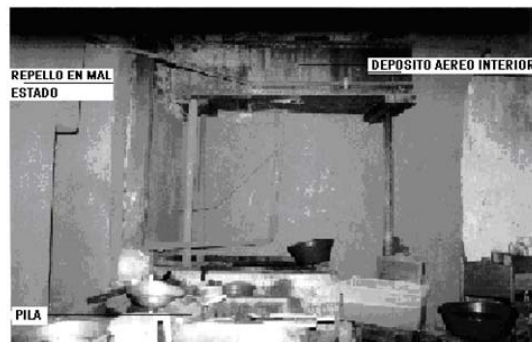
FOTO 60 AREA DE PILA Y DEPOSITO DE AGUA
