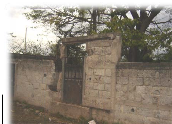
Fotografía 2.4.6.b. Como en la fotografía anterior, sus paredes se encuentran deterioradas, y en muy mal estado
