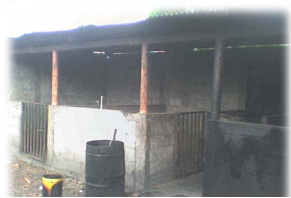
Fotografía 2.4.6.d. Otras áreas que no son utilizadas, que también se encuentran en mal estado.
