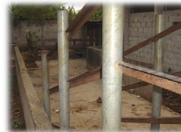
Fotografía 2.4.6.c. El Anden se encuentra deteriorado le hace falta pintura anticorrosiva
