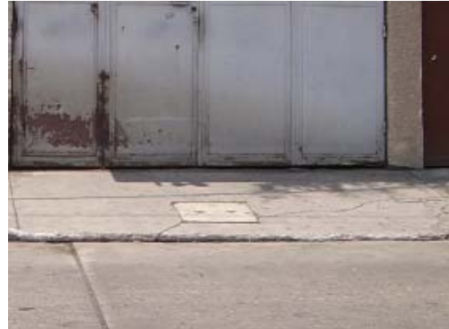
Fotografía 18. Deterioro de tapaderas de cajas de agua potable. Ubicación 12 calle entre 12 avenida y 13 avenida, zona 1, Barrio Gerona, ciudad de Guatemala.
