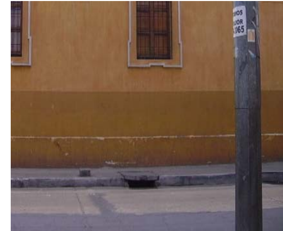
Fotografía 13. Ayuda al deterioro de las banquetas la ubicación de cajas o drenajes que no cuentan con mantenimiento. Ubicación 12 avenida esquina 11 calle, zona 1, Barrio Gerona, ciudad de Guatemala.
