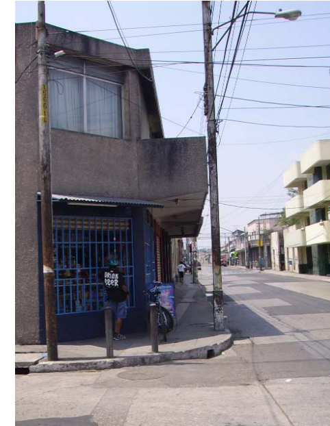
Fotografía 17. Poste de concreto con luminaria y de tendido eléctrico. Ubicación 12 calle esquina 12 avenida, zona 1, Barrio Gerona, ciudad de Guatemala.
