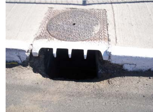
Fotografía 19. Tragante de tapadera cuadrada metálica. Ubicación 13 calle esquina 14 avenida, zona 1, Barrio Gerona, ciudad de Guatemala.
