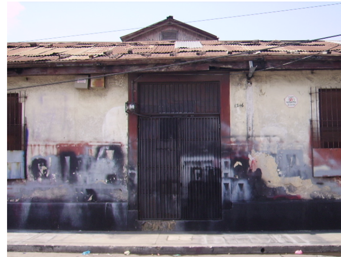
Fotografía 23. Existencia de gran contaminación visual, principalmente por medio de grafitos. Ubicación 12 calle entre 12 avenida y 13 avenida, zona 1, Barrio Gerona, ciudad de Guatemala.
