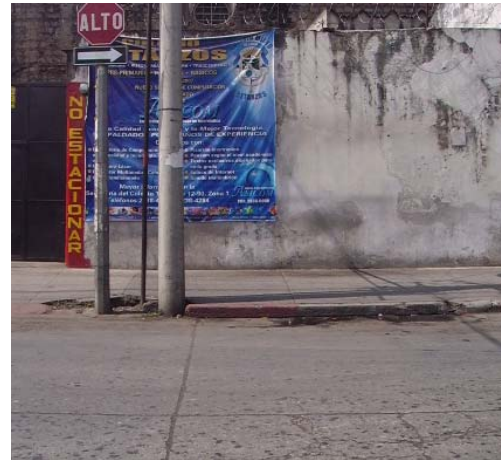
Fotografía 12. Alto grado de deterioro en las banquetas. Ubicación 10ma. Calle esquina 13 avenida, zona 1, Barrio Gerona, ciudad de Guatemala.
