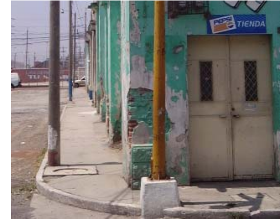
Fotografía 15. El ancho de las banquetas no es el apropiado para la ubicación de infraestructuras. Ubicación 12 calle "A2" esquina 14 avenida, zona 1, Barrio Gerona, ciudad de Guatemala.
