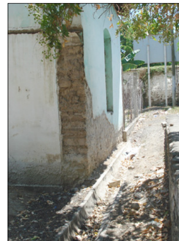
Fotografía No. 98 Estado de conservación fachada nor-oeste. Deterioro del muro de adobe con repello de cemento.
