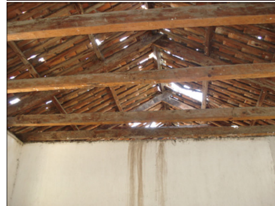
Fotografía No. 109 Deterioro del techo
