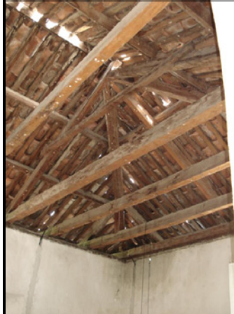
Fotografía No.106 Estado del artesanado de madera
