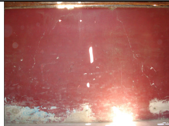
Fotografía No. 107 Estado de conservación fachada suroeste Deterioros: decoloración, fisuras en piso, desprendimiento de materiales, alteración en muros y crecimiento de vegetación.
