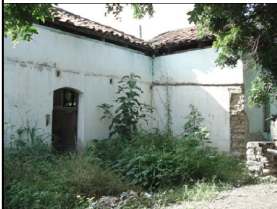
Fotografía No. 95 Estado de conservación fachada noroeste Deterioros: decoloración, fisuras, desprendimiento de materiales, humedad, alteración de repello, destrucción de muro y techo.
