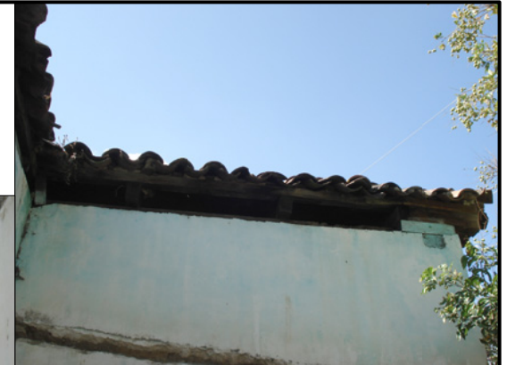
Fotografía No. 96 Estado de conservación fachada noroeste Deterioros: en solera de amarre, falta el techo.
