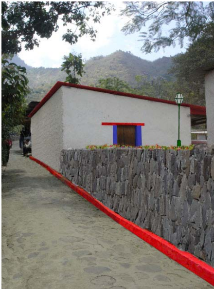
Fotografía 43. Muro de piedra provisional, la vivienda muestra características de la arquitectura vernácula, como material de los muros, estilo de la ventana, presentando deterioro en ventana, presencia de suciedad en los muros. Fotografía 44. Propuesta. Realización de muro de piedra, área jardinizada, implementación de color en muros, mejoras a la estructura de la ventana, limpieza de fachada, mejora en caminamiento.
