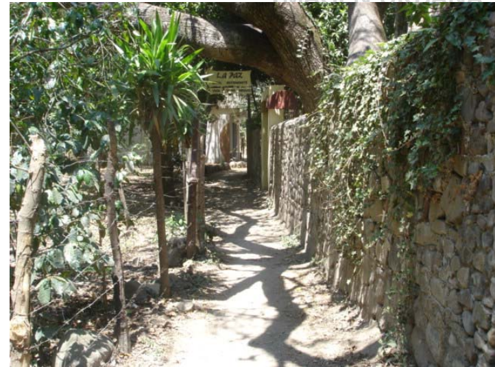
Fotografía 33. El caminamiento se encuentra sin adoquín, el muro de piedra se encuentra sucio, el cerco del terreno no está hecho con material de la región (caña), existe vegetación dañina, en los muros de el ingreso al restaurante La Paz deterioro por suciedad y humedad.
