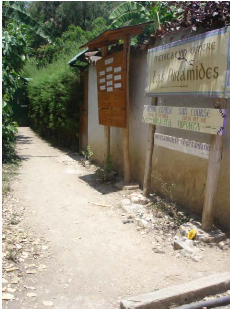
Fotografía 51. Se encuentran colocados dos tipos de carteleros y basura debajo de estos, el muro de la fachada presenta suciedad y moho, el caminamiento es de tierra, falta de área jardinizada.
