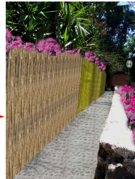
Fotografía 41. Cerco con alambre espigado, caminamiento de tierra, muro sucio y con moho.
