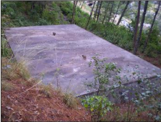
Tanque municipal de agua potable a 100 mts del ingreso que proviene de la carretera principal 12 NA. ubicado en el sitio de estudio
