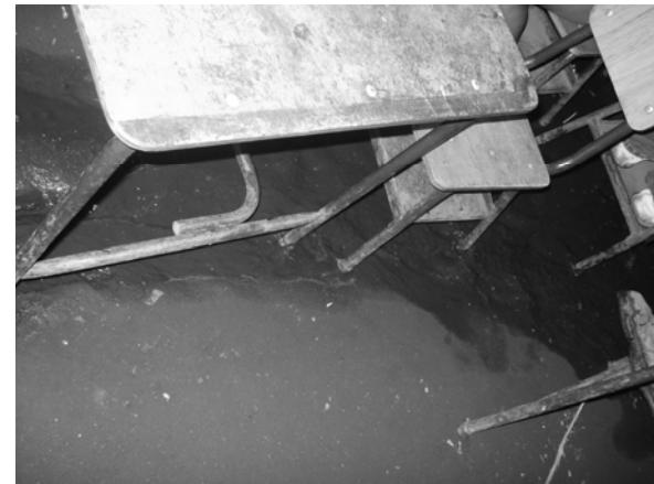
Foto 03. Observamos en otra aula vecina el estado del mobiliario a causa del filtramiento de aguas pluviales, por carencia de drenajes.
