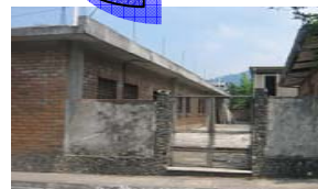
Fotografía No. 11 Estado actual ingreso principal Centro Educativo.
