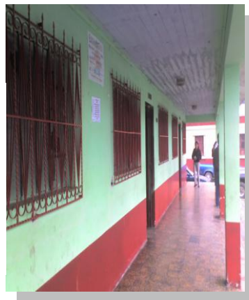
Fotografía No.2.4.1.4 Corredor del interior del actual Edificio Municipal, Imagen: Leticia Bautista
