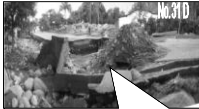
Aldea Nahualate, Carretera en mal estado
