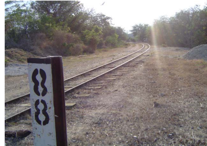
Foto 22 Poste Milla 88. Puede verse el ambiente que rodea la línea
