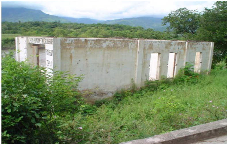
Foto 3 La fachada no cuenta con puertas ni ventanas, no tiene techo y la vegetación cubre parte de las paredes. Milla 94.3
