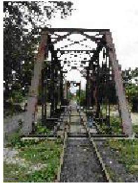
Foto 16. Puente sobre la vía férrea muy cerca de destruido en toda la estación de Zacapa.
