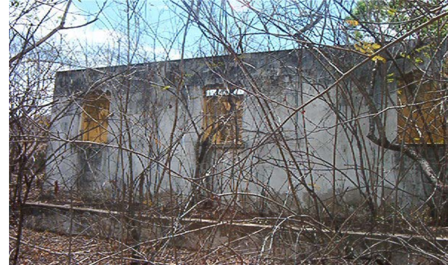
Foto 36 Milla 98 donde funciono el albergue para personal del ferrocarril. En la foto lo que queda de la estación mampostería y concreto
