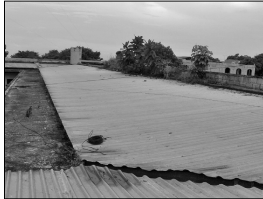
FOTO No.75. Vista estado de techos de norte a sur
