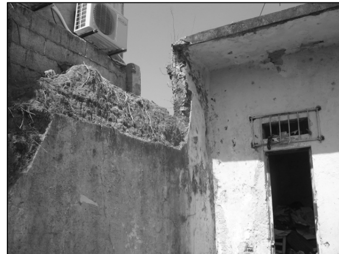
Muro colindante deteriorado de adobe
