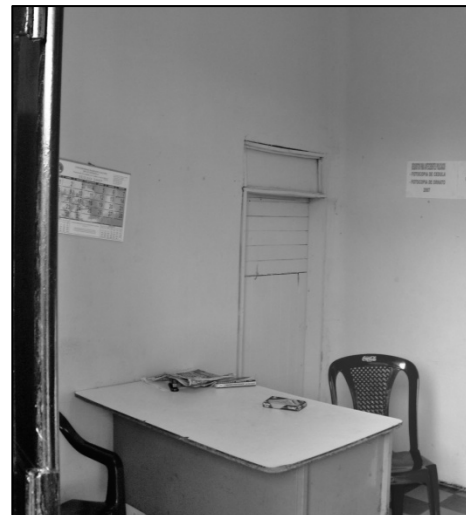
FOTO No.74. Estado de muros en oficina secretaria
