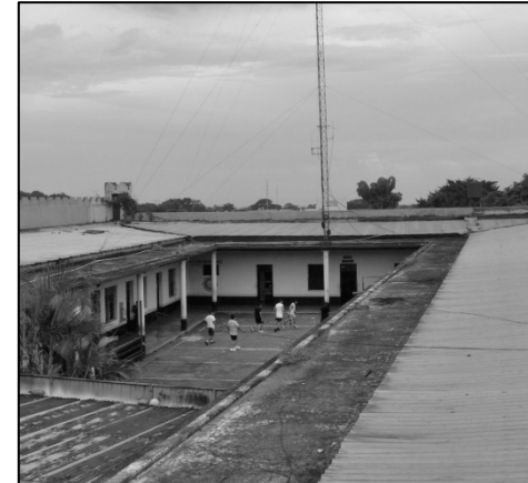
FOTO No.77. Estado de cornisa en corredor
