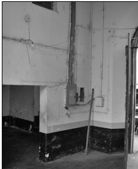
FOTO No.30. Tablero de Distribución en ingreso
