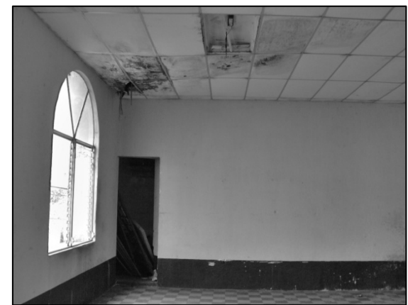
FOTO No.46. Estado cielo falso en salón usos múltiples
