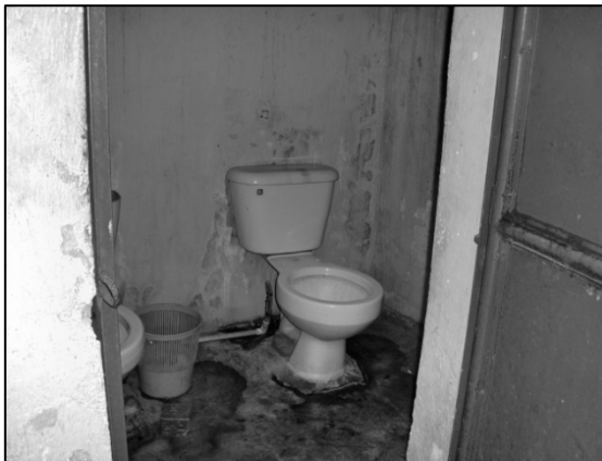
FOTO No.52. Estado de batería de sanitarios en patio
