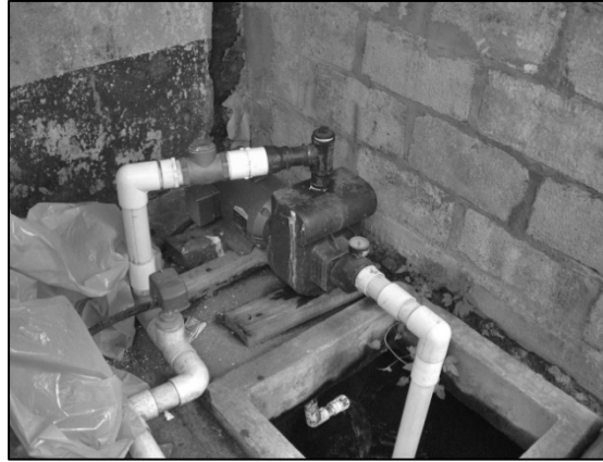
FOTO No.50. Bomba hidroneumática contigua a duchas
