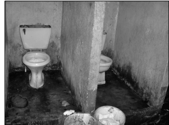
FOTO No.34. Estado de servicios sanitarios sótano
