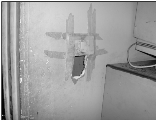
FOTO No.73. Daños en tabiques oficina secretaria
