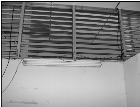
FOTO No.57. Instalaciones eléctricas en oficina apoyo
