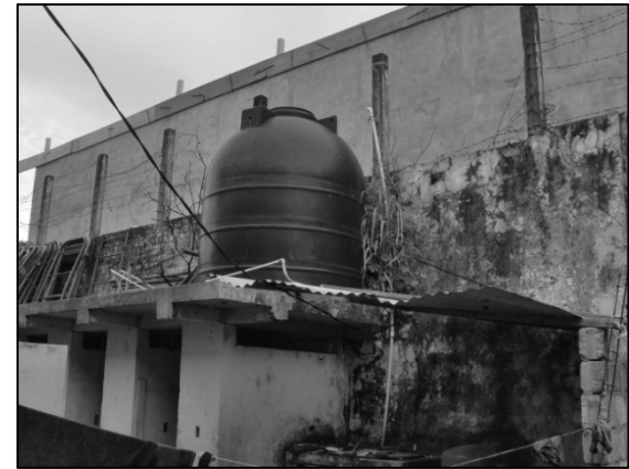
FOTO No.51. Tanque elevado sobre batería de duchas
