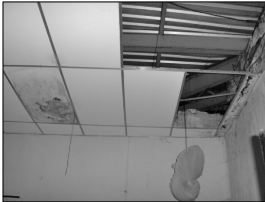
FOTO No.40. Daños en cielo falso por filtración de agua
