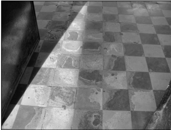
FOTO No.44. Piso desgastado ingreso salón usos M.
