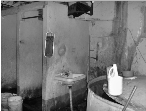
FOTO No.32. Instalaciones servicios sanitarios sótano
