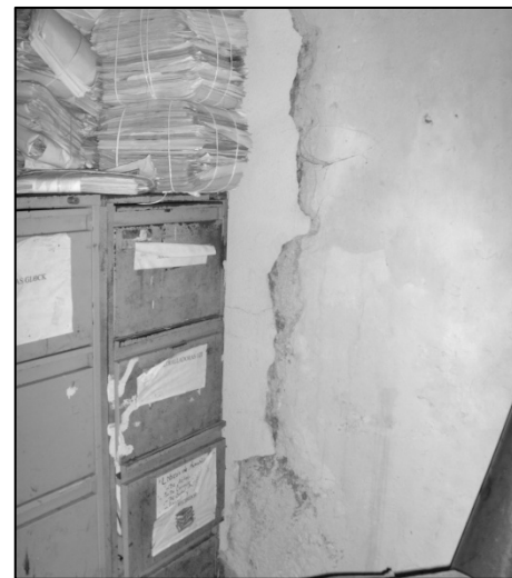
FOTO No.58. Humedad y grietas en muro oficina apoyo
