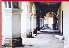
Arcadas de ladrillo: entripso con Tendales de madera y baldosas de Barro cocido.
