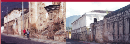
FACHADA PONIENTE Con presencia de grietas, cuarteaduras, Falta cornisa, parapeto, Gárgolas de piedra, repello, etc.
