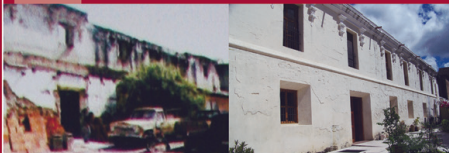
FACHADA SUR Vanos parcialmente tapiados, grietas, Cuarteaduras, falta: cornisa, Parapeto, gárgolas de barro cocido, Repellos, etc.
