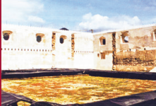
Muros interiores de la esquina de dos niveles, en la que se pueden observar los vestigios de las arcadas, vanos de puertas y ventana, altura del entrespiso, adornos, etc. Todo en el interior del Claustro fue demolido.
