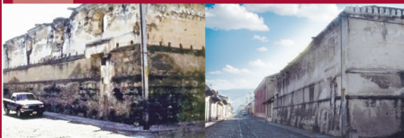
FACHADA NORTE Dintel de ventana desfasado, grietas, Cuarteaduras, falta: El Parapeto, Repellos, gárgolas de piedra, etc.
