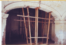
Daños en arcos y bóvedas: fisuras, grietas, cuarteaduras, falta de repellos y alteración del color y piso.
