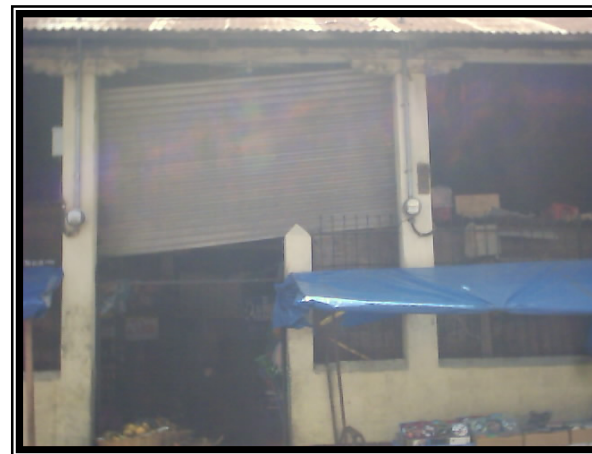
Fotografía 3.7.1. Ingreso principal del actual Mercado Municipal del Municipio de Ciudad Vieja. El edificio se encuentra en deterioro.
