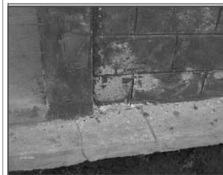
Foto No.5 y 6: erosión en paredes por humedad
