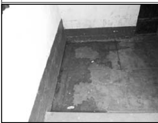
Foto No.1: area con fugas de agua potable
