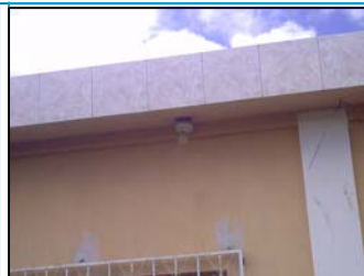
Foto No.3: instalaciones electricas ocultas
