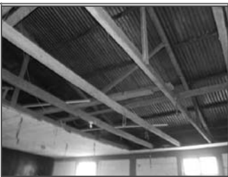
Foto No.2: la estructura del techo y las laminas se encuentran en regular estado
