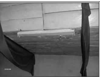
Foto No.3: instalaciones electricas en malas condiciones
