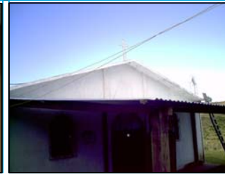
Foto No.3: instalaciones electricas expuestas
