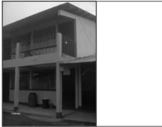
Foto No.1: perspectiva del edificio, techo de dos aguas de lamina zinc.
