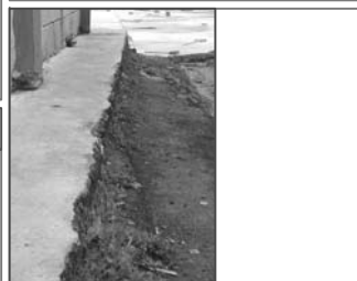
Foto No.2: torta de concreto exterior deteriorada por la humedad
