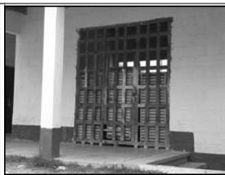
Foto No.3: puerta de madera malas condiciones
