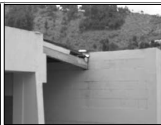
Foto No.4: area deteriorada, anclaje entre losa y lamina
