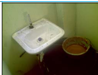
Foto No.3: instalaciones deterioradas
