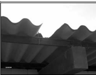
Foto No.2: la estructura del techo y las laminas se encuentran en regular estado
