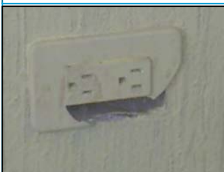
Foto No.1: instalaciones en mal estado
