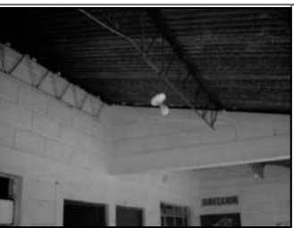
Foto No.3: instalaciones electricas expuestas
