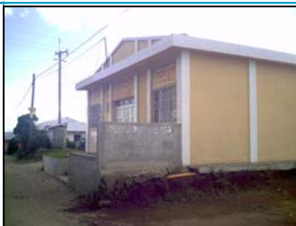
Foto No.2: tuberia de agua pluvial expuesta
