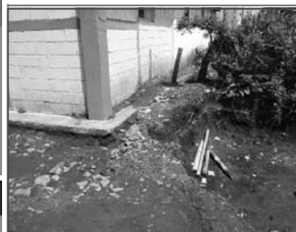
Foto No.3: los alrededores de la edificación se encuentra deteriorados causando erosión en algunas partes de los muros.
