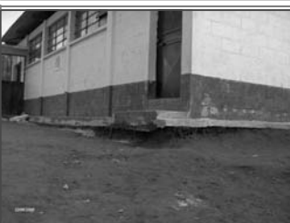
Foto No.3: los alrededores de la edificación se encuentra deteriorados cuasando erosión en algunas partes del cimientto.
