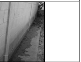
Foto No.4: humedad en paredes
