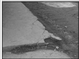
Foto No.5 y 6: torta de concreto agrietada y tubería de pvc expuesta
