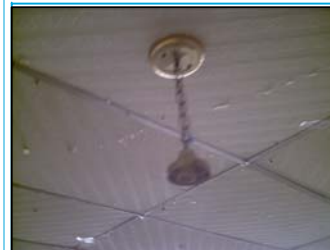
Foto No.5 y 6: instalaciones electricas malas
