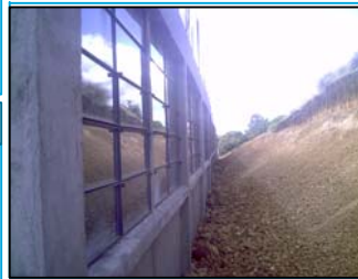
Foto No.2: talud existe en la parte posterior del edificio aun sin tratar
