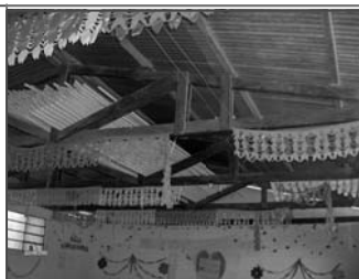
Foto No.2: la estructura del techo y las laminas se encuentran en buen estado
