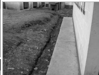
Foto No.3: los alrededores de la edificación se encuentra deteriorados causando erosión en algunas partes del cemento.
