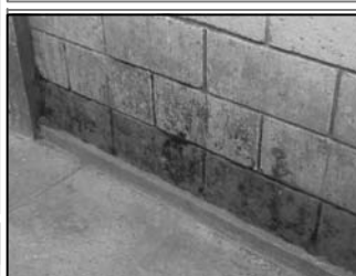
Foto No.3: los alrededores de la edificación se encuentra deteriorados causando erosión en algunas partes de los muros.
