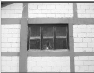
Foto No.1: se puede observar que las condiciones de las ventanas de este edificio se encuentran en mal estado.
