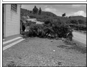
Foto No.4: humedad en paredes
