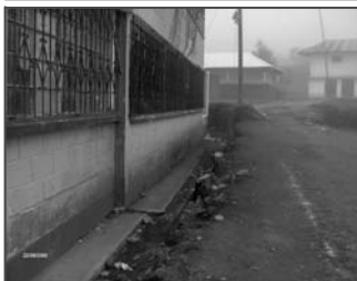
Foto No.3: los alrededores de la edificación se encuentra deteriorados causando erosión en algunas partes del cimiento.
