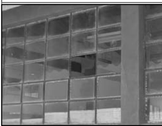
Foto No.1: se puede observar que las condiciones de las ventanas de este edificio se encuentran en mal estado.
