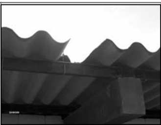
Foto No.2: la estructura del techo y las laminas se encuentran en regular estado
