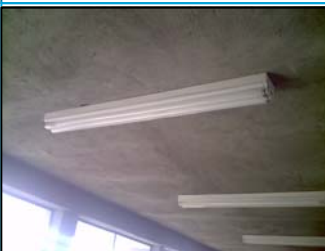
Foto No.1: instalaciones electricas ocultas y en buen estado.
