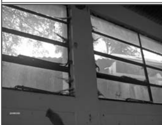
Foto No.1: se puede observar que las condiciones de las ventanas de este edificio se encuentran en mal estado.
