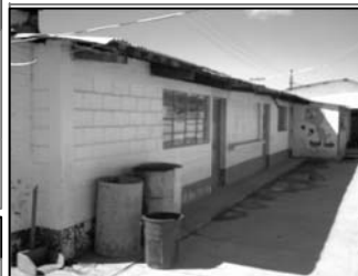
Foto No.3: area del edificio con humedad alrededor
