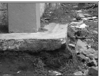
Foto No.3: cimentacion expuesta
