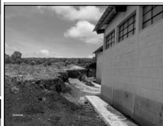
Foto No.3: humedad en paredes debido a que no hay tratamiento en talud existente
