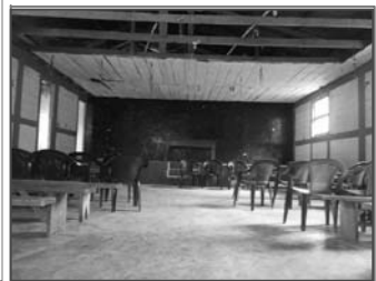
Foto No.4: columnas ya no cumplen funcion
