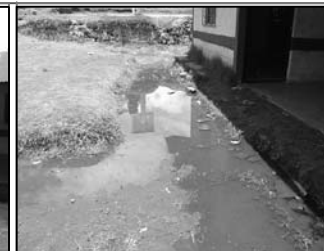
Foto No.4: agua estancada obstruyendo el ingreso
