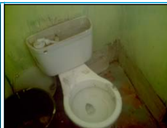
Foto No.4: inodoro en mal estado
