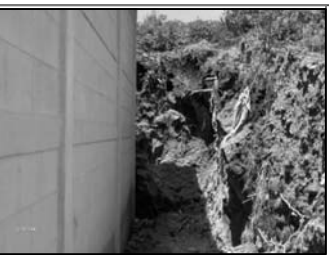
Foto No.3: falta de muro perimetral y tratamiento de talud existente
