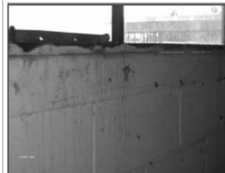
Foto No.4: cimentación expuesta
