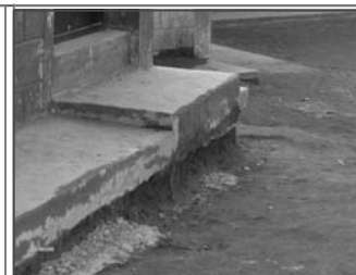
Foto No.4: cimentación expuesta
