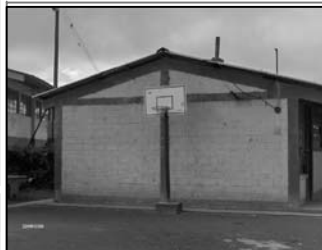
Foto No.1: perspectiva del edificio, techo de dos aguas de lamina zinc.
