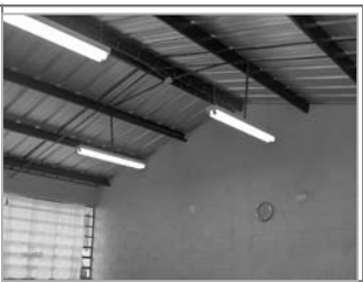
Foto No.2: la estructura del techo es nueva y en optimas condiciones.
