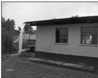
Foto No.2: se puede observar una de las aulas del edificio que se encuentra en regular estado.
