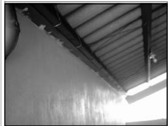
Foto No.5 y 6: instalaciones electricas expuestas
