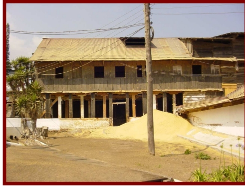
BENEFICIO DE CAFÉ ESTADO ORIGINAL, ESTRUCTURA DAÑADA POR POLILLA. fotografía propia, ubicación Sur Oeste. ref. D en gráfico NO.1 "B" y
