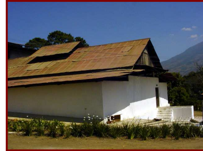
AREA DE PRODUCCIÓN, VISTA POSTERIOR DEL BENEFICIO Fotografía propia No 54, ubicación centro del casco Referencia, inciso 9 gráfico NO. 5
