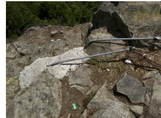
INFRAESTRUCTURA EXISTENTE DETERIORADA E INSUFICIENTE
