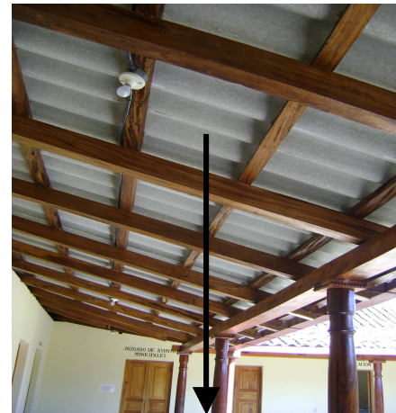
FOTOGRAFÍA No 26: ARMADO INTERIOR DE DURALITA + TENDALES + TEJAS, LAS COLUMNAS ESTÁN EMPOTRADAS JUNTO CON LOS TENDALES.
