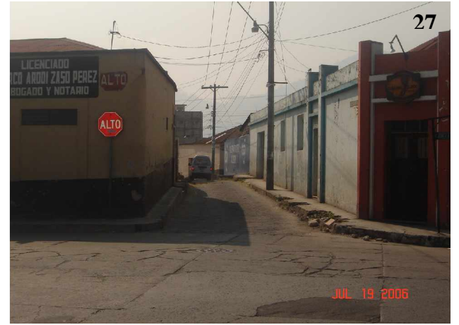
Deterioro Físico: Presencia de grietas en el pavimento de la calle. Deterioros Conceptuales: Falta de unidad constructiva en la calle (empedrado + carrileras de adoquín y de concreto)
