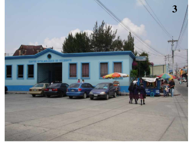
Deterioro Conceptual: Contaminación visual por postes de energía eléctrica. Agrietamiento en pavimento de las avenidas.
