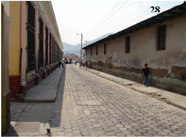
Deterioros Físicos: Faltantes en acabados en pared del antiguo Hospital San Juan de Dios y presencia de humedad. Falta de unidad constructiva en la acera del Hospital. Deterioros Físicos: Por el uso de materiales ajenos al lugar, como la utilización de adoquín.
