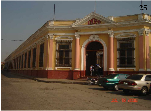
Deterioros Físicos: Por el uso de materiales ajenos al lugar, como la utilización de adoquín.
