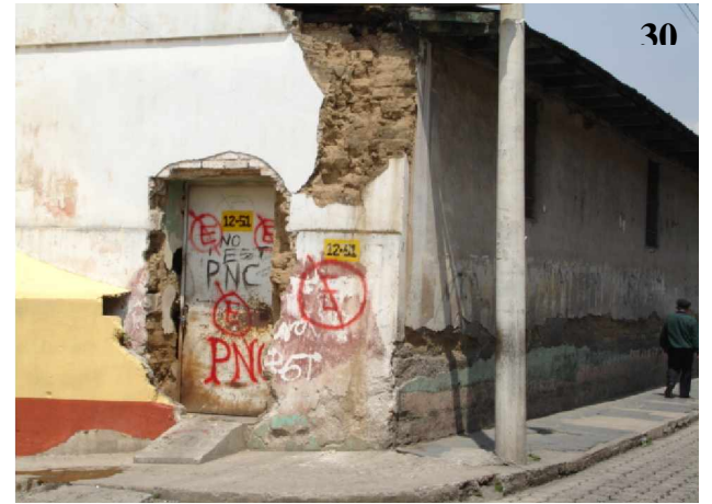
Deterioros Físicos: Faltantes en acabados en pared del antiguo Hospital San Juan de Dios y presencia de humedad. Falta de unidad constructiva en la pared del Hospital. Deterioro Conceptual: Poste de alumbrado público.
