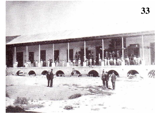
Aspectos de la construcción de los dormitorios del "Instituto Nacional"; "Escuela Práctica"; "Instituto Nacional de Varones" y el actual de "Instituto Nacional para Varones de Occidente", según Acuerdo Gubernativo, de las recordadas Catacumbas.
