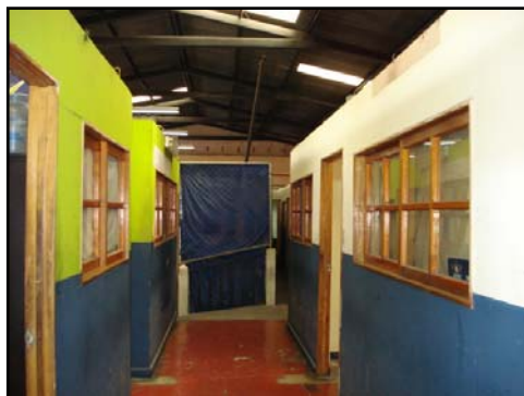
Foto 15: Falta de espacio para oficinas
