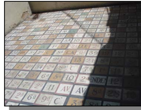
Fotografía 5: Ambientes sin techo y con piso de nomenclatura sobrante
