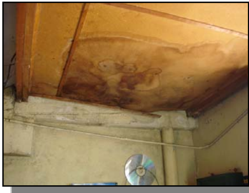
Fotografía 4: Gráfica de humedad en el techo área administrativa
