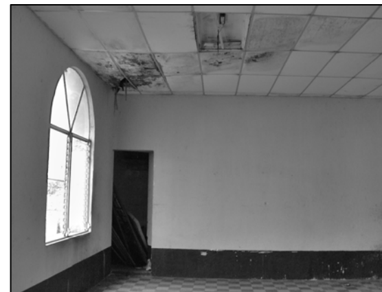
FOTO No.46. Estado cielo falso en salón usos múltiples
