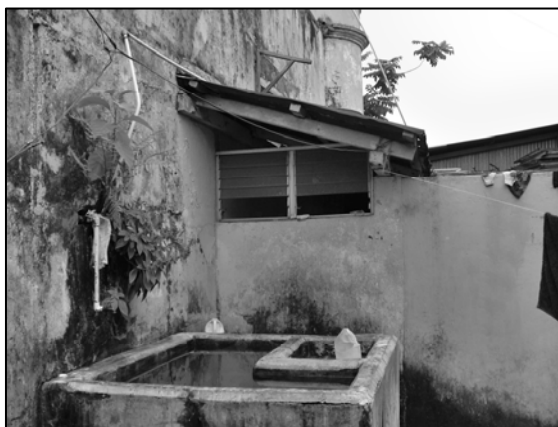
FOTO No.49. Batería de sanitarios patio trasero
