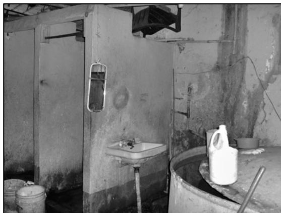
FOTO No.32. Instalaciones servicios sanitarios sótano
