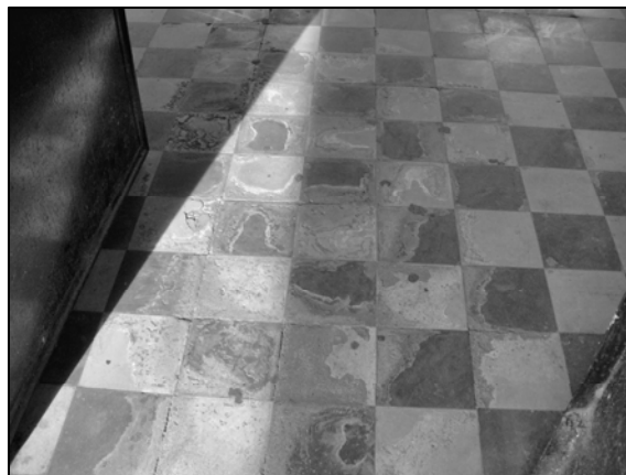
FOTO No.44. Piso desgastado ingreso salón usos M.
