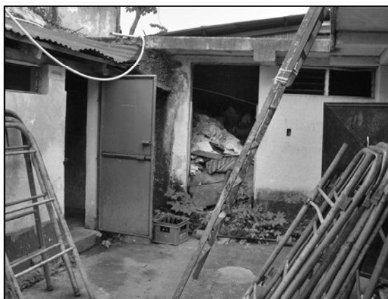
FOTO No.53. Estado de bodega en patio trasero
