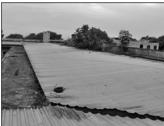
FOTO No.75. Vista estado de techos de Norte a Sur
