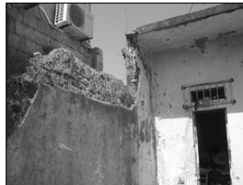
Muro colindante deteriorado de adobe
