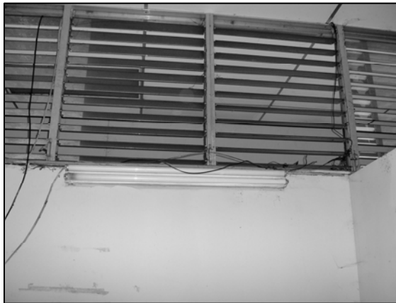
FOTO No.57. Instalaciones eléctricas en oficina apoyo
