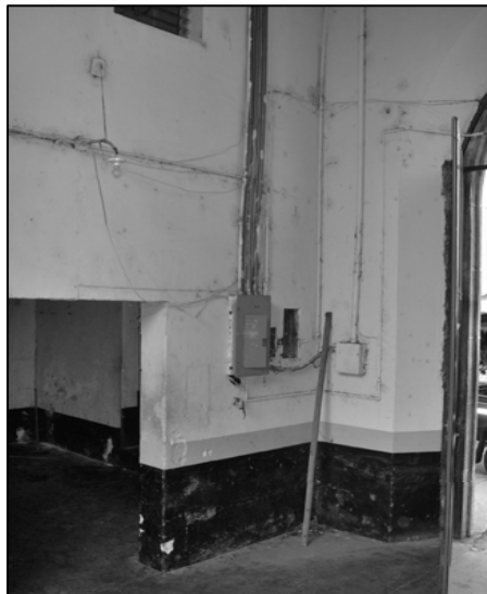
FOTO No.30. Tablero de Distribución en ingreso
