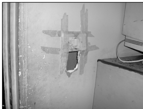
FOTO No.73. Daños en tabiques oficina secretaria
