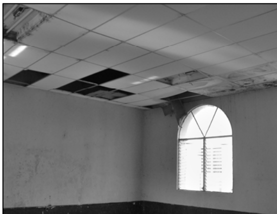
FOTO No.45. Estado cielo Falso en salón usos múltiples
