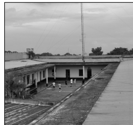
FOTO No.77. Estado de cornisa en corredor
