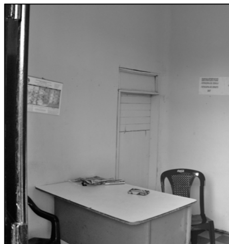
FOTO No.74. Estado de muros en oficina secretaria
