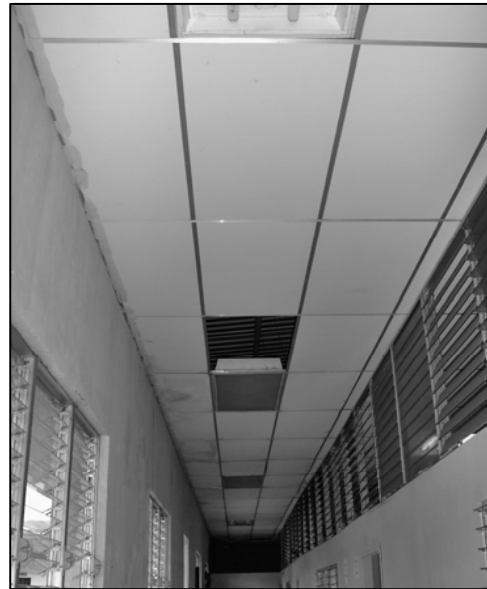
FOTO No.60. Estado cielo falso corredor interno Oeste
