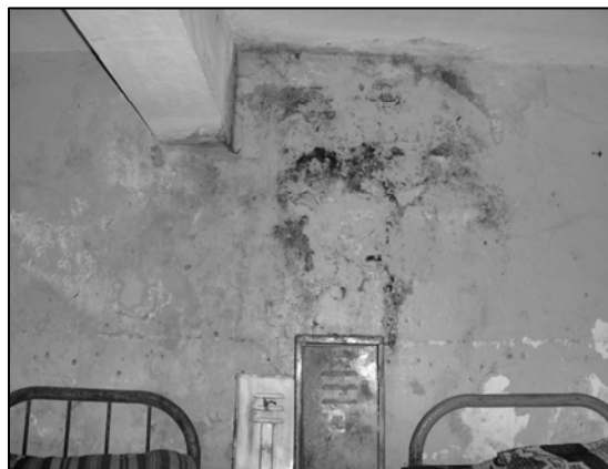
FOTO No.33. Humedad en muro dormitorios de sótano
