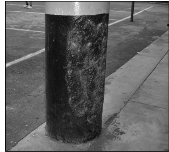
FOTO No.56. Daños a columna en patio central
