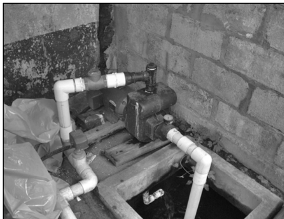
FOTO No.50. Bomba hidroneumática contigua a duchas
