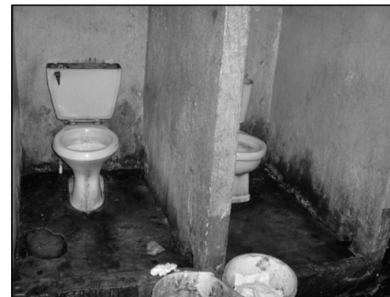
FOTO No.34. Estado de servicios sanitarios sótano
