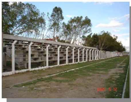
Foto 8 Vista de graderíos y pista de atletismo; en cuanto a los graderíos se encuentran deteriorados y sin baranda de seguridad. La “pista” se encuentra con irregularidades en toda su extensión.
