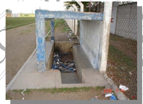
Foto 12 Este es el área de banca que por falta de mantenimiento y de uso, se ha llenado de basura. El estado actual es precario.
