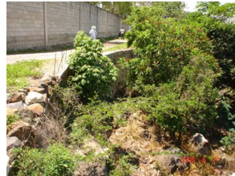
Foto 3 Vista Sur-Oeste. El muro se ha reforzado presenta rajaduras. Al fondo se observa el graderío del Coliseo, (actualmente se encuentra en abandono).
