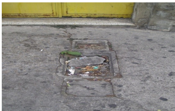
Imagen 58: Estado actual de banquetas. Se observa el deterioro en esta área debido al agrietamiento desde las diferentes cajas existentes. Autor: A. Jurado. Diciembre 2008.
