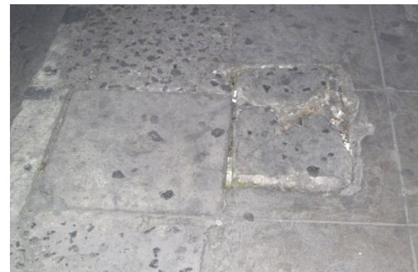
Imagen 67: Infraestructura; Agua Potable. Se observa una tapadera partida por la mitad y en mal estado, al igual que las restantes del área. Autor: A. Jurado. Diciembre 2008.
