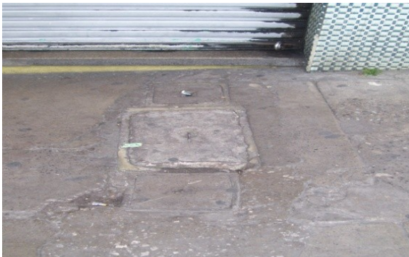
Imagen 65: Infraestructura; Agua Potable. Se observan los diferentes problemas que presenta esta instalación, hoyos a su alrededor, tapaderas viejas rajadas y tapaderas que no caben en el espacio designado para su uso. Autor: A. Jurado. Diciembre 2008
