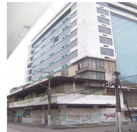
Imagen 144: Usos del Suelo; Sin Uso. Este inmueble era el antiguo Hotel Ritz y se encuentra aparentemente abandonado, representa un punto de reunión de indigentes en el sector y hospedaje en sus banquetas. Autor: A. Jurado. Diciembre 2008.
