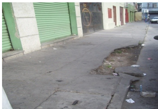
Imagen 60: Estado actual de banquetas. Se observa que debido a que el área es utilizada para parqueos, algunas partes de la banqueta han sido escindidas. Autor: A. Jurado. Diciembre 2008
