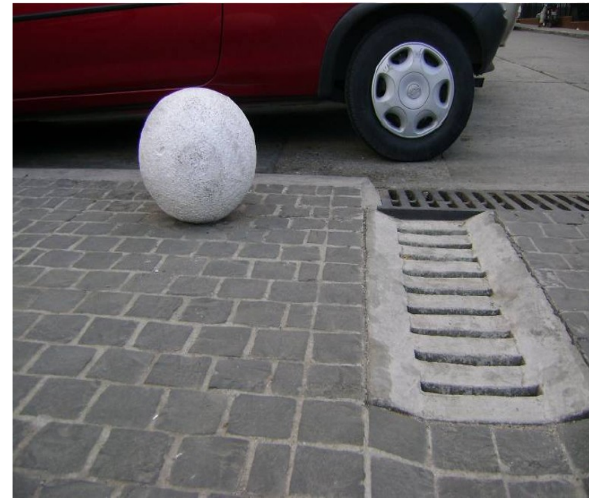
REGILLA DE CONCRETO ARMADO AGUAS PLUVIALES
