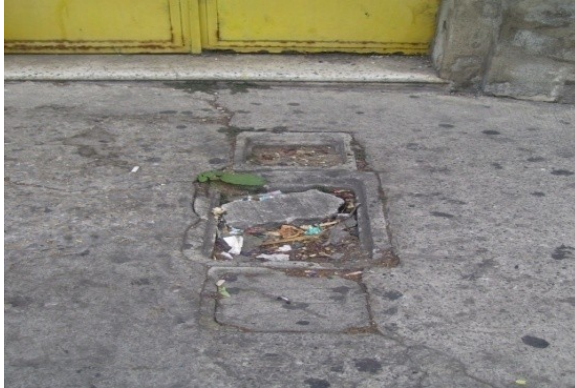
Imagen 64: Infraestructura; Agua Potable. Se observa el alto deterioro de las tapaderas que como en este caso se encuentra partida por la mitad y el agrietamiento que existe a su alrededor. Autor: A. Jurado. Diciembre 2008.
