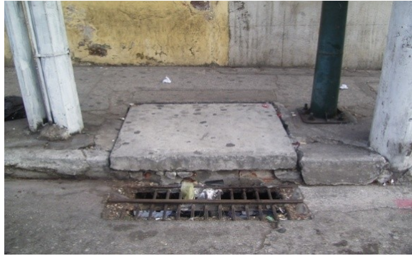
Imagen 70: Infraestructura; Drenajes. En esta fotografía se puede apreciar otro diseño de tapadera y que en caso especial incluye una rejilla con varillas de hierro que retienen basura. Autor: A. Jurado. Diciembre 2008.
