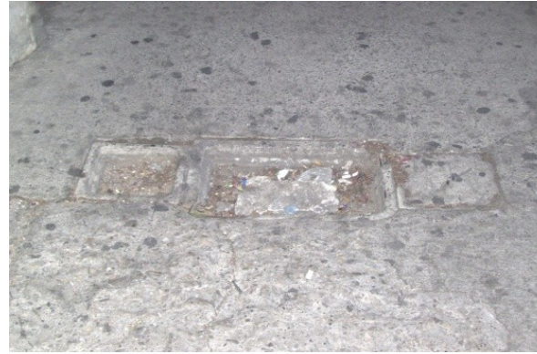
Imagen 66: Infraestructura; Agua Potable. Se observa que algunas de las tapaderas de concreto han sido removidas por su mal estado. Autor: A. Jurado Diciembre 2008.
