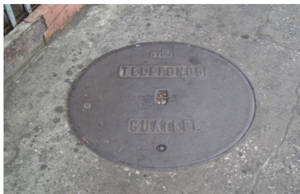
Imagen 78: Infraestructura; Telefonía Pública. A todo lo largo del callejón y calle se encuentran las cajas de registro subterráneo en diseño rectangular y tapadera circular. Autor: A. Jurado. Diciembre 2008.
