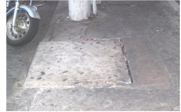
Imagen 68: Infraestructura; Drenajes. Esta tapadera se encuentra en un estado deplorable, los agrietamientos causados por la tapadera han llegado hasta el poste de luz eléctrica. Autor: A. Jurado. Diciembre 2008.
