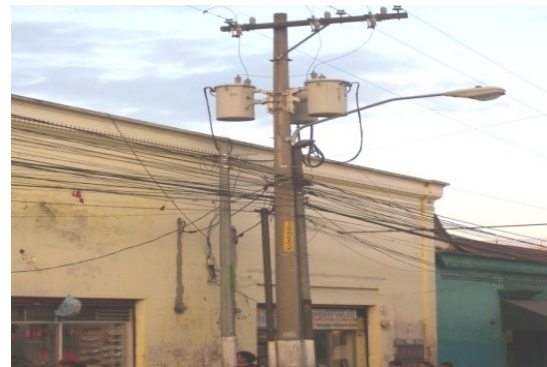
Imagen 73: Infraestructura; Iluminación Pública. Se observa uno de los postes que cuenta con tres transformadores ubicado en 11 calle. Autor: A. Jurado, Diciembre 2008.
