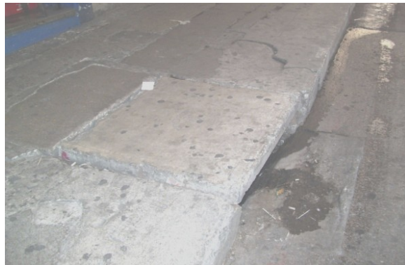
Imagen 71: Infraestructura; Drenajes. Podemos encontrar seis drenajes pluviales en el tramo de la 11 calle y uno en el Callejón Tasso en su mayoría las tapaderas se encuentran en mal estado y levantadas a nivel de la banqueta. Autor: A. Jurado. Diciembre 2008.
