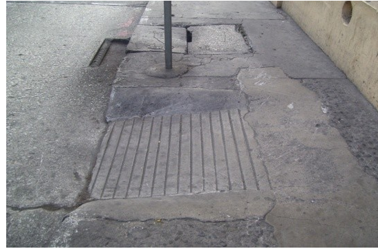
Imagen 72: Infraestructura; Drenajes. Podemos observar que los registros domiciliarios de aguas servidas en su mayoría se encuentran en mal estado. Autor: A. Jurado. Diciembre 2008.
