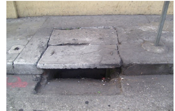
Imagen 69: Infraestructura; Drenajes. Se observa que la tapadera se encuentra en mal estado. Autor: A. Jurado. Diciembre 2008.
