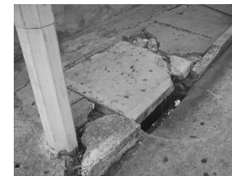
Fotografía 17: Infraestructura; Drenajes. Esta tapadera se encuentra en un estado deplorable, que inclusive el poste de corre riesgo de caer debido a que se tambalea con el viento y el movimiento.
