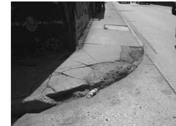
Fotografía 9: Estado actual de banquetas. Se observa que no existen rampas para minusválidos en ninguna de las esquinas de las intersecciones.
