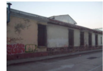
Fotografía 12: Usos del suelo. Edificación categoría B" Alquiler de cuartos para vivienda muy mal estado físico.
