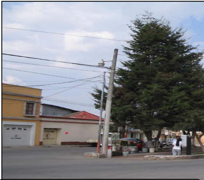
No.36 En la fotografía se observa el tipo de alumbrado público actual de la plaza y tal es el deterioro que produce riesgo ya que se encuentra inclinado hacia atrás. Fuente: Autor.
