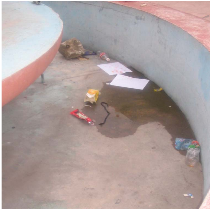
No.45 En la fotografía se observa la fuente en su estado actual y la basura que se encuentra en una parte de ella. Fuente: Autor.
