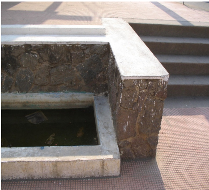
No.46 La fotografía muestra el estado actual de la pileta y la suciedad en que se encuentra.
