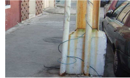
Fotografía 17: Infraestructura; Televisión por Cable. Los postes del servicio del cable se localizan junto a los postes de energía eléctrica. Autor: Manuel Soto, Octubre 2008.
