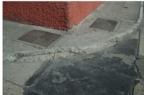
Fotografía 4: Estado actual de banquetas. Se observa que no existen rampas para minusválidos en ninguna de las esquinas de las intersecciones. Autor: Manuel Soto, Octubre 2008.
