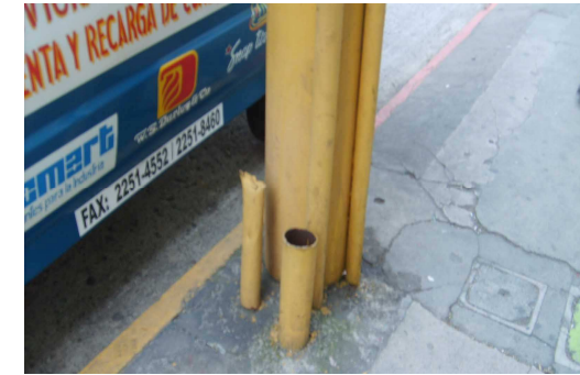
Fotografía 18: Infraestructura; Televisión por Cable. Existen postes que han sido removidos pero que por haber estado fundidos en la banqueta únicamente fueron cortados, dejando aún parte de las bases. Autor: Manuel Soto, Octubre 2008.
