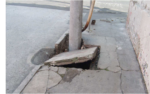
Fotografía 5: Infraestructura; Drenajes. Esta tapadera se encuentra en un estado deplorable, que inclusive el poste de luz eléctrica corre riesgo de caer debido a que se tambalea con el viento y el movimiento. Autor: Manuel Soto, Octubre 2008.
