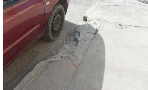
Fotografía 3: Estado actual de banquetas. Se observa que debido a que el área es utilizada para parqueos, algunas partes de la banqueta han sido escindidas. Autor: Manuel Soto, Octubre 2008
