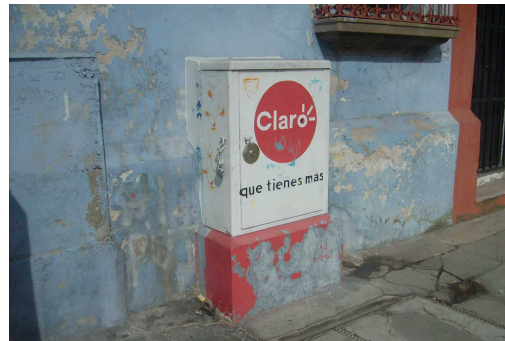
Fotografía 16: Infraestructura; Telefonía Pública. También encontramos cajas de registro tipo armario de la compañía Claro, éstas se convierten por sus salientes en focos de contaminación. Autor: Manuel Soto, Octubre 2008.
