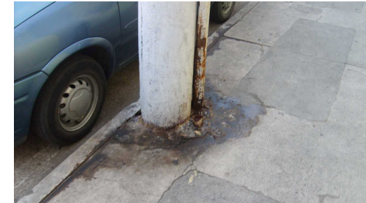
Fotografía 14: Contaminación Ambiental; Desechos Sólidos, Fecalidad y Orina. Los postes del alumbrado eléctrico también son utilizados como puntos para realizar evacuación de fluidos corporales. Autor: Manuel Soto, Octubre 2008.
