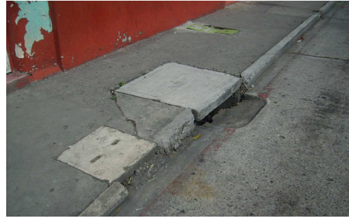
Fotografía 9: Infraestructura; Drenajes. Podemos observar que los registros domiciliarios de aguas servidas en su mayoría se encuentran en buen estado mas no así sus alrededores. Autor: Manuel Soto, Octubre 2008.
