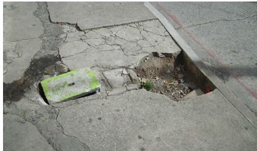
Fotografía 2: Infraestructura; Agua Potable. Se observa los diferentes problemas que presenta esta instalación, hoyos a su alrededor, tapaderas viejas rajadas y tapaderas que no caben en el espacio designado para su uso. Autor: Manuel Soto, Octubre 2008
