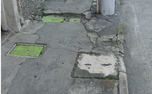
Fotografía 1: Estado actual de banquetas. Se observa el deterioro en esta área debido al agrietamiento desde las diferentes cajas existentes. Autor: Manuel Soto, Octubre 2008.
