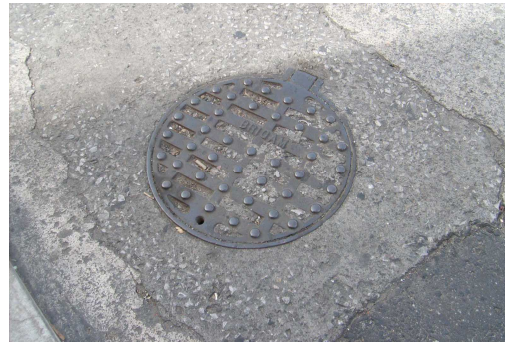
Fotografía 4: Infraestructura; Agua Potable. Se observa una tapadera donde se encuentran válvulas generales para el abastecimiento del servicio de agua potable en este sector. Autor: Manuel Soto, Octubre 2008.
