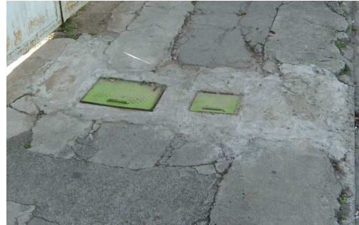
Fotografía 3: Infraestructura; Agua Potable. Se observa que algunas de las tapaderas de concreto han sido remplazadas por tapaderas metálicas. Autor: Manuel Soto, Octubre 2008.
