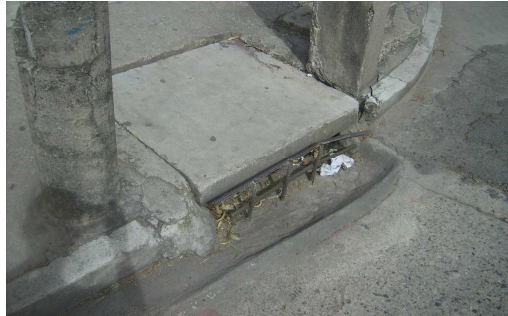
Fotografía 7: Infraestructura; Drenajes. En esta fotografía se puede apreciar otro diseño de tapadera y que en caso especial incluye una rejilla con varillas de hierro que retienen basura. Autor: Manuel Soto, Octubre 2008.
