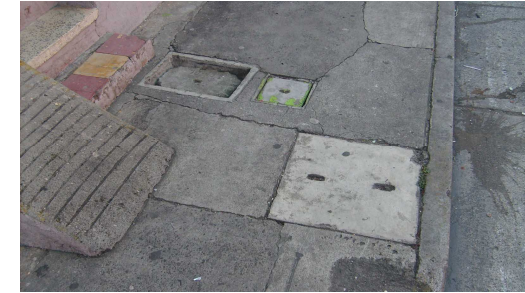
Fotografía 5: Estado actual de banquetas. Se observa la falta de uniformidad en los ingresos vehiculares y a casas, que incluso como en este caso constituyen un obstáculo para el peatón. Autor: Manuel Soto, Octubre 2008.
