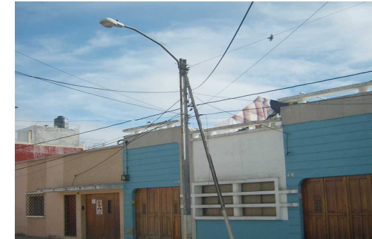
Fotografía 12: Infraestructura; Iluminación Pública. Se observa uno de los postes de metal con base de concreto. Autor: Manuel Soto, Octubre 2008.
