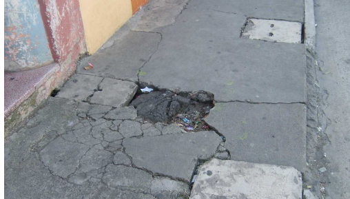
Fotografía 1: Infraestructura; Agua Potable. Se observa el alto deterioro de las tapaderas que como en este caso se encuentra partida por la mitad y el agrietamiento que existe a su alrededor. Autor: Manuel Soto, Octubre 2008.
