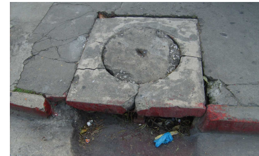
Fotografía 6: Infraestructura; Drenajes. Se observa que la tapadera se encuentra en mal estado y que retiene en su ingreso basura. Autor: Manuel Soto, Octubre 2008.
