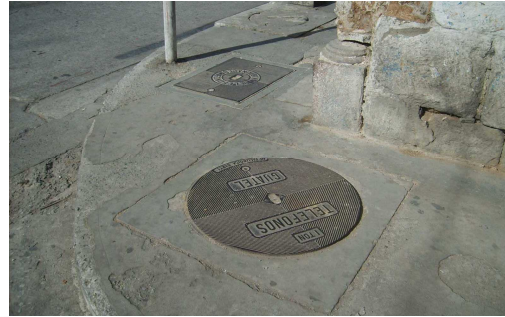
Fotografía 15: Infraestructura; Telefonía Pública. A todo lo largo del callejón se encuentran las cajas de registro subterráneo en diseño rectangular y circular. Autor: Manuel Soto, Octubre 2008.
