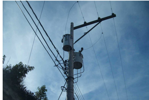
Fotografía 10: Infraestructura; Iluminación Pública. Se observa uno de los postes que cuenta con dos transformadores ubicado entre la 5ª y la 7ª calles. Autor: Manuel Soto, Octubre 2008.
