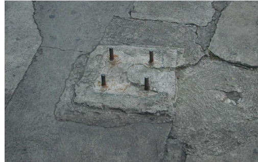
Fotografía 3: Señalización; Semáforos. Anteriormente el callejón contaba con semáforos en otras esquinas, que fueron removidos, parcialmente, convirtiéndose en un obstáculo para el peatón. Autor: Manuel Soto, Octubre 2008.
