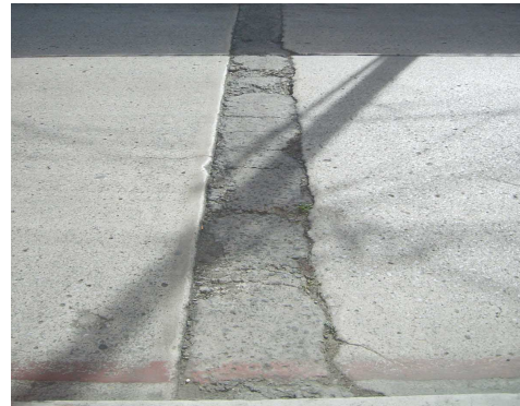
Fotografía 2: Área del Vehículo. En este caso se observa que el concreto de la calle se encuentra reemplazado debido a trabajos de excavación que se realizaron por parte de la empresa de telefonía pública. Autor: Manuel Soto, Octubre 2008.
