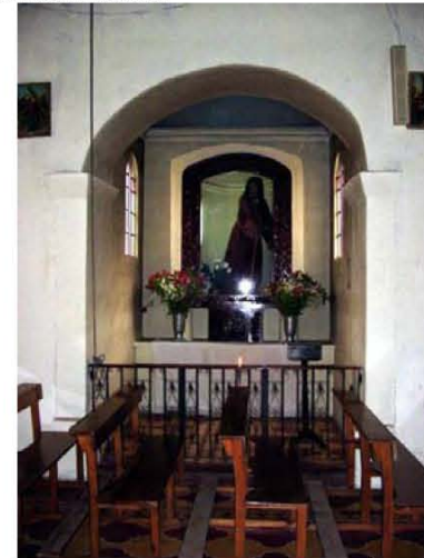
ESTE ARCO TAMBIÉN PRESENTA LA FALTA DE SUPERVISIÓN ADECUADA AL LEVANTAR LA ESTRUCTURA, NÓTENSE LOS EXTREMOS DEL ARCO, SE ENCUENTRAN ASIMÉTRICOS.
