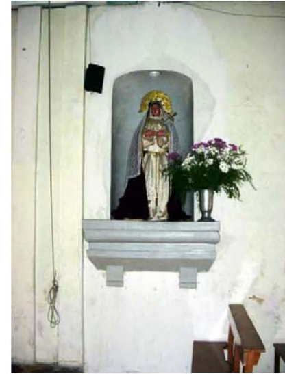
SE INTERVINO LA ESTRUCTURA, AGREGANDO DOS NICHOS, SIN CONSIDERAR EL POSIBLE DEBILITAMIENTO DEL MURO.
