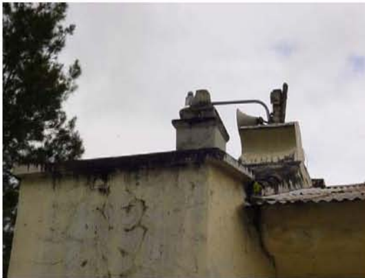
EL EXCESO DE HUMEDAD HA PROVOCADO AGRIETAMIENTOS EN LAS JUNTAS DE LA ESTRUCTURA.
