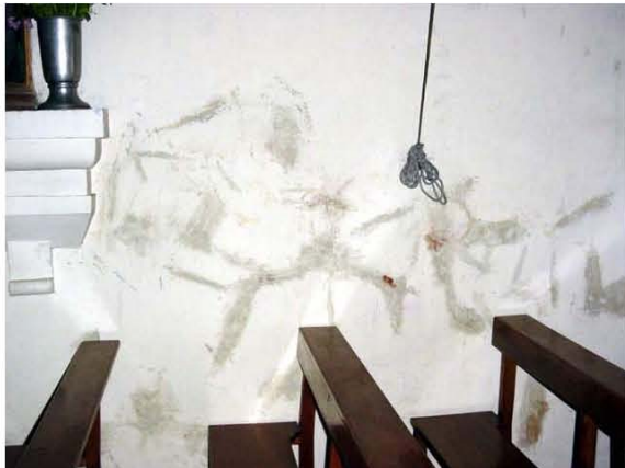
INTERVENCIÓNES EN POSIBLES AGRIETAMIENTOS O RECONSTRUCCIÓN DE ALGUNA DE LAS PARTES DEL MURO.
