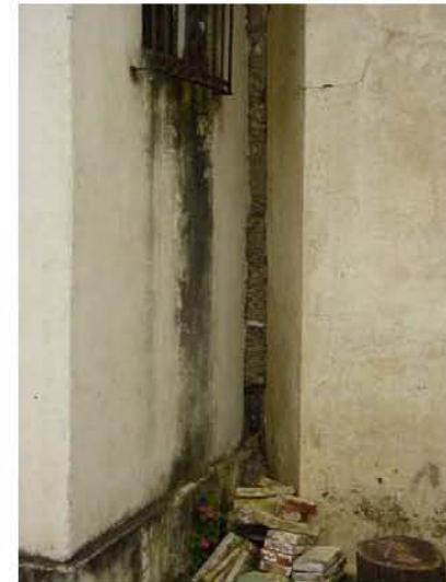
LAS ESCORRENTÍAS PLUVIALES SOBRE LOS MUROS GENERAN MOHOS QUE VAN DETERIORANDO LOS ENLUCIDOS DE LA ESTRUCTURA.
