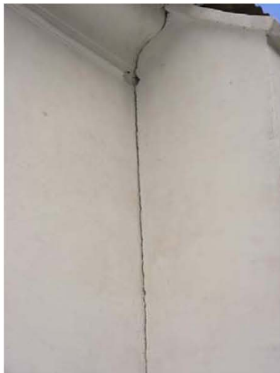
LOS MUROS MUESTRAN UN DESPRENDIMIENTO EN LA UNIÓN CON LAS COLUMNAS, POSIBLEMENTE ESTE DESPRENDIMIENTO SEA A NIVEL DEL REPELLO.
