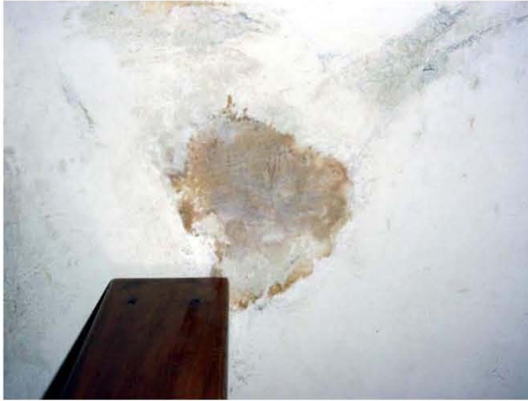
EN EL INTERIOR DE LA IGLESIA A PESAR DE TENER PINTURA RECIENTE, SE NOTAN APARICIONES DE HUMEDAD QUE AFECTAN LOS MATERIALES EN LOS ENLUCIDOS.
