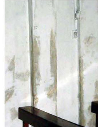
ELEMENTOS INTERVENIDOS, QUE DE ALGUNA MANERA SE HAN EFECTUADO MAL, EL DESPLOME QUE PRESENTAN LOS ACABADOS DENOTAN MALA EJECUCIÓN EN LA ELABORACIÓN DE LA INTERVENCIÓN.
