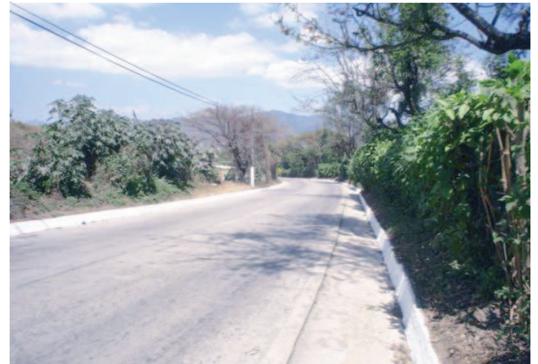
FOTO 53 CUNETAS EN VÍA PRINCIPAL COLINDANTE SE OBSERVA LA CUNETETA REALIZADA PARA DRENAR EL AGUA QUE VIENE DEL NORTE HACIA EL SUR, POR ESTAR EN UN NIVEL MÁS BAJO EL AGUA SE ACUMULA HASTA ALCANZAR LOS 0.40mt.
