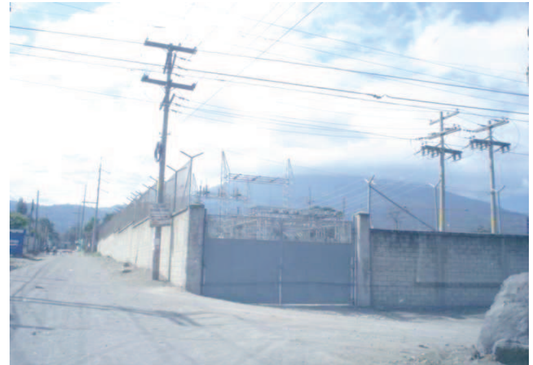
FOTO 47 FUENTE: Propia LOCALIZACIÓN DE PLANTA GENERADORA DE ENERGÍA ELÉCTRICA, VÍA QUE SE DIRIGE HACIA PLAZA E IGLESIA LA ERMITA
