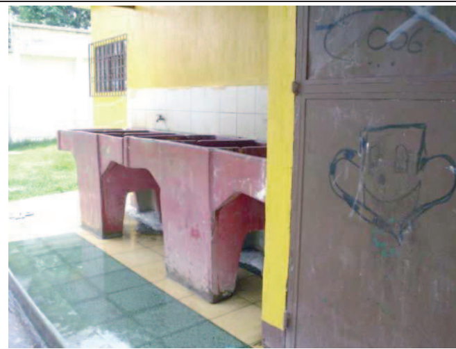
Foto 18. Cuarto de servicio, en donde se ubica el calentador eléctrico, así como el área de lavandería con 2 pilas.
