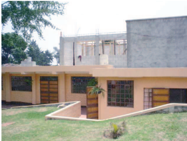
Foto 9. Área de cocina, Comedor, Aula de Computación, Bodega general, y Construcción de salón para distintas actividades.
