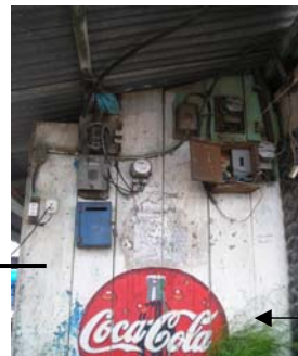
Fotografía 48: Vista de las condiciones de las pocas instalaciones eléctricas que posee el mercado.
