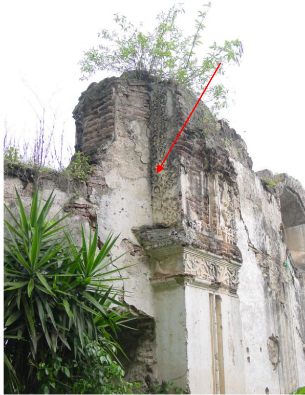
Grieta de separación entre el muro sur y la pilastra
