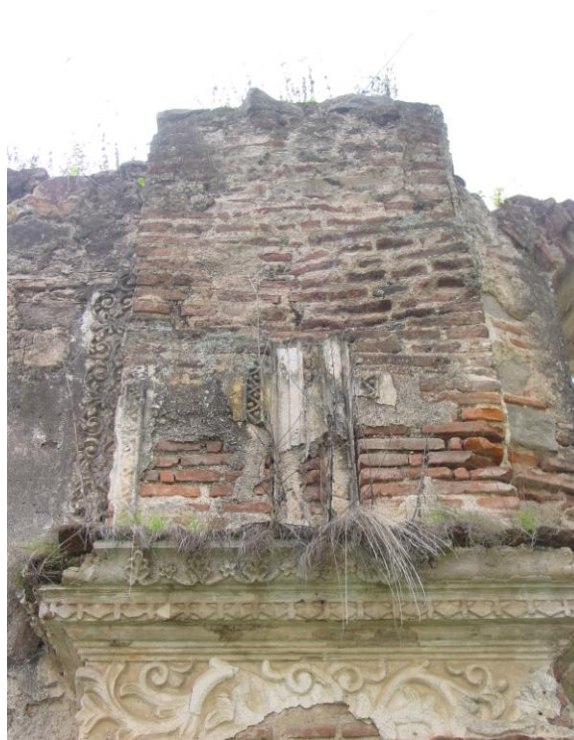
Pilastra muro norte, evidencia de pérdida del estuco decorativo
