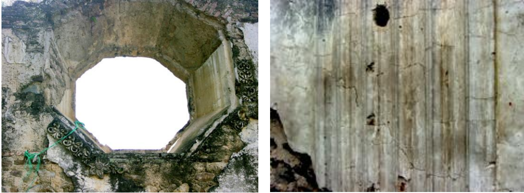
Desprendimiento estucos de ventanas y molduras verticales decorativas en el interior de la nave
