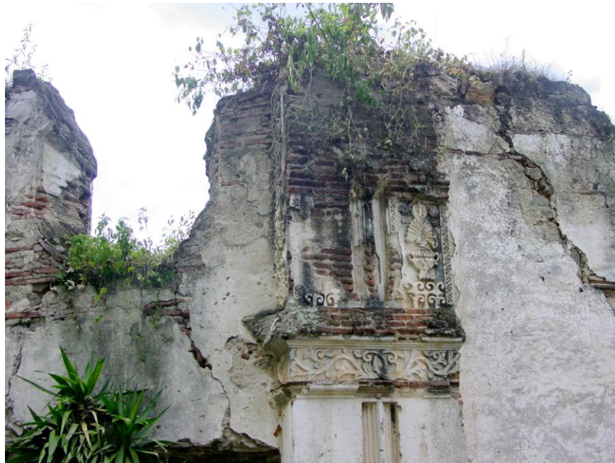
Grietas de muros por sismos
