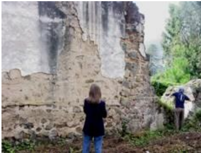
La falta de repello en los muros permite la filtración de agua
