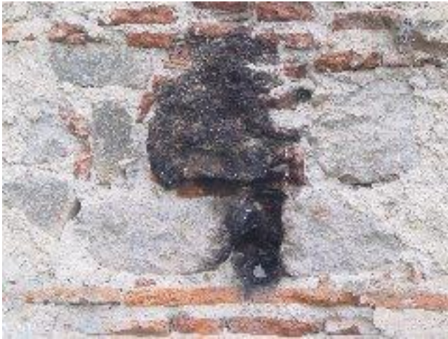
Panal de avispas, muro Norte exterior
