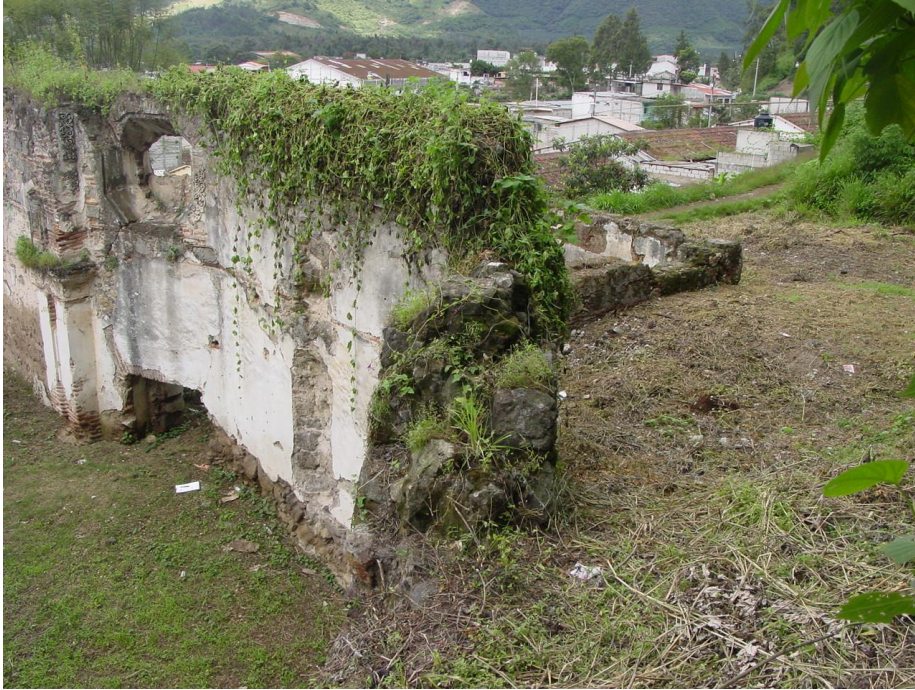
Muro norte, se observan las grietas horizontales y el asolvamiento
