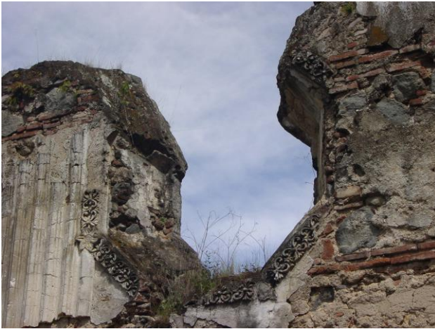
Friso decorativo de las ventanas y moldura, falta de materiales en la parte superior de la ventana
