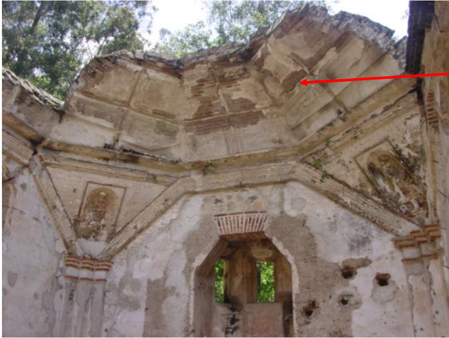
Restos de la cubierta de mampostería del presbiterio de la ermita de Dolores del Cerro, de forma octogonal.
