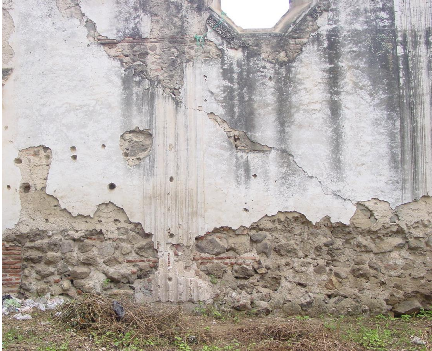
Manchas oscuras de escurrimiento de agua de lluvia y pérdida de aplanados
