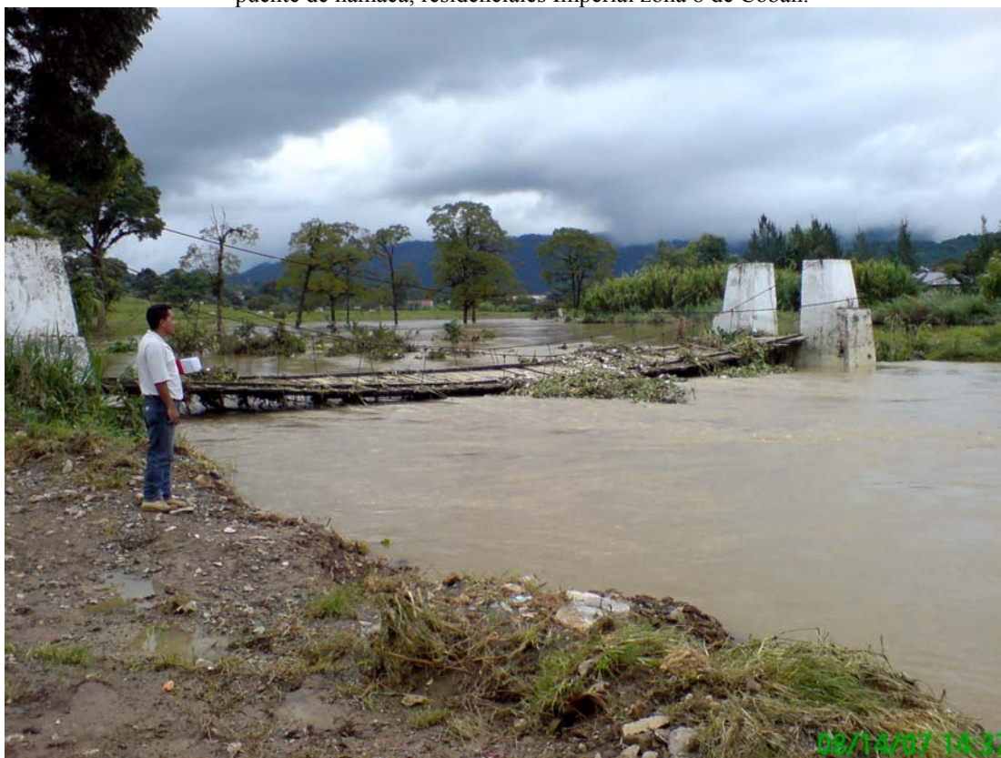
FOTOGRAFÍA 7.9 Muestra depósitos fluviales en un extremo del río Cahabón a inmediaciones del puente de hamaca, residenciales Imperial zona 8 de Cobán.
