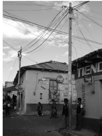
Fotografía No. 121 Tendido eléctrico Contaminación Visual Fuente: Elaboración propia
