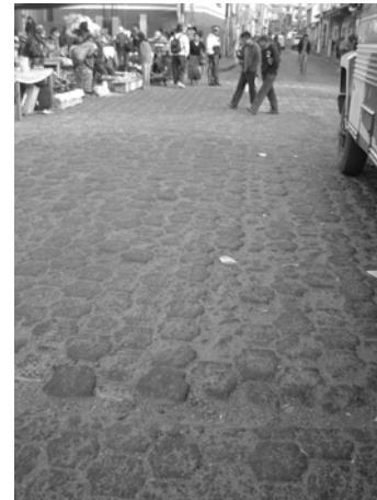
Fotografía No. 79 7ma avenida frente al parque central Por la constante circulación de transporte pesado se ha desgastado el adoquinado. Fuente: Elaboración propia
