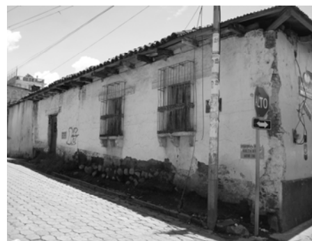
Fotografía No.53 12 calle y 7ma avenida esquina Contaminación por heces Fecales y orina Fuente: Elaboración propia
