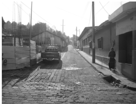
Fotografía No.76 9na calle y 7ma avenida Calle adoquinada con Hundimientos Fuente: Elaboración propia
