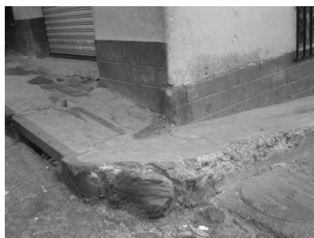
Fotografía No 65 7ma avenida y 1 calle esquina Debido al transporte pesado que circula en estas calles se han deteriorado más las banquetas y no se les ha dado mantenimiento Fuente: Elaboración propia
