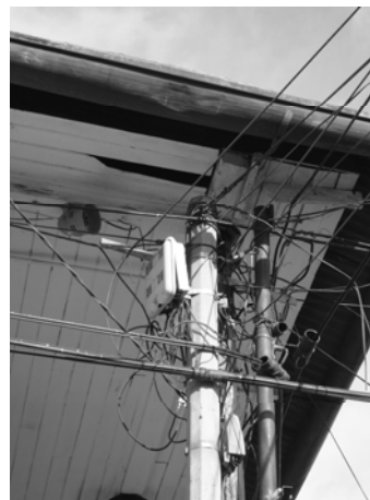
Fotografía No. 117 Aglomeración de cables Contaminación visual y Peligro de quemarse vivienda Fuente: Elaboración propia
