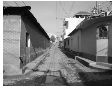
Fotografía No.77 7MA CALLE Y 7MA AVENIDA ESQUINA Hundimiento en adoquinado Fuente: Elaboración propia
