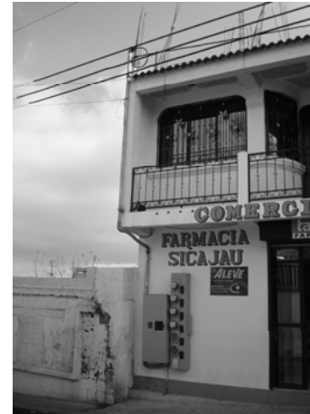
Fotografía No. 122 Acometida eléctrica Contaminación visual por acometidas eléctricas sobre fachada Fuente: Elaboración propia
