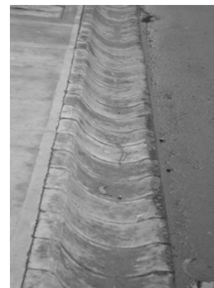
Fotografía No. 115 Rigola Conducción de agua pluvial
