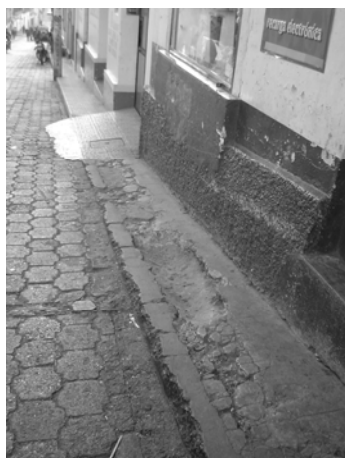
Fotografía No.66 11 calle y 7ma avenida Calle que conduce a Panajachel, las banquetas están en mal estado. Fuente: Elaboración propia
