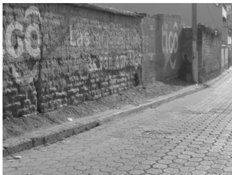
Fotografía No.64 6ta avenida y 7ma calle Tramos de Banqueta sin construir Fuente: Elaboración propia
