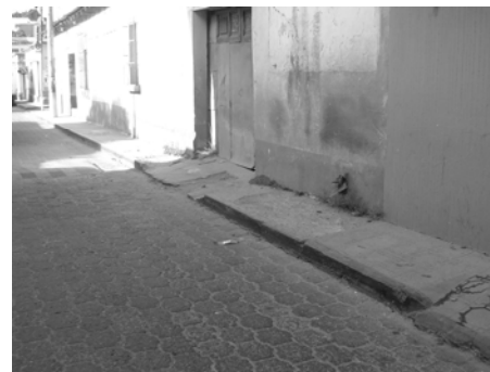
Fotografía No.63 6ta avenida y 6ta calle Banqueta en mal estado Fuente: Elaboración propia
