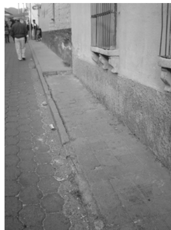
Fotografía No.67 12 calle y 7ma avenida Bordillo y banqueta en mal estado, con diferentes niveles y texturas Fuente: Elaboración propia
