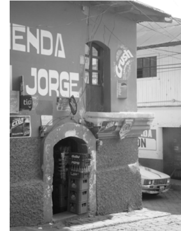
Fotografía No. 123 Acometida eléctrica Contaminación visual por acometidas eléctricas en fachada Fuente: Elaboración propia
