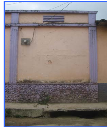
Fotografía No 5 Único drenaje de agua pluvial del casco urbano Fotografía: Gustavo A Chacón
