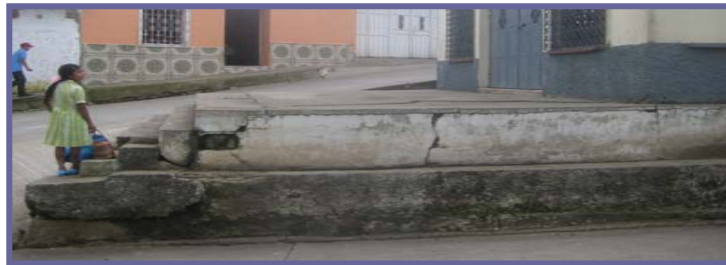
Fotografía No. 127 Deterioro de banquetas y tamaño de muros Fotografías: Gustavo A Chacón
