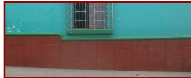
Fotografía No. 124 Zócalo alisado Fotografías: G. Chacón
