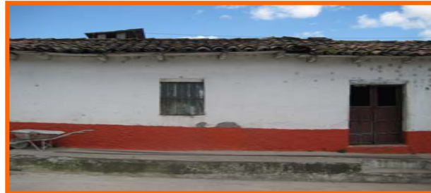
Fotografía No. 131 Techos deteriorados y muros sucios Fotografía: Gustavo A Chacón
