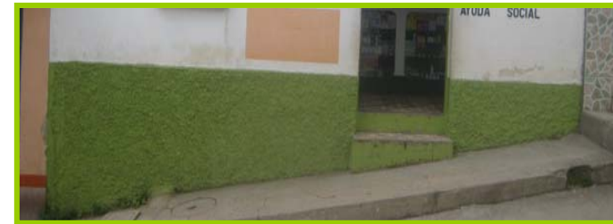
Fotografía No. 53 Alteraciones de altura en zócalos Fotografías: Gustavo A Chacón
