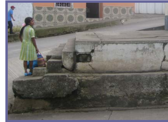
Fotografía No. 13 Banquetas deterioradas Fotografías: Gustavo A Chacón
