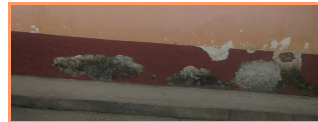
Fotografía No. 123 Zócalo de pintura, deteriorado
