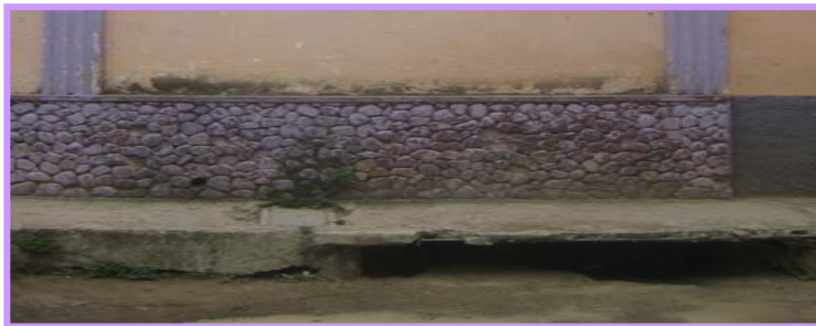
Fotografía No. 85 Único drenaje Pluvial Fotografía: Gustavo A Chacón
