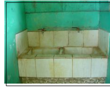
LOS ARTEFACTOS DEL SERVICIOS SANITARIOS DE HOMBRES EN MALAS CONDICIONES
