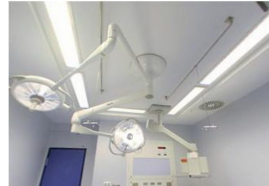
Quirófanos: Instalaciones especiales previstas y buena iluminación y sistema de aire acondicionado.
