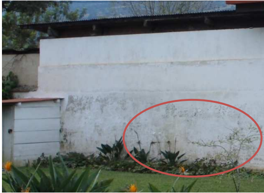
FOTOGRAFIA No. 3 DETERIORO EN PINTURA POR HUMEDAD A. Aguilar Cabrera
