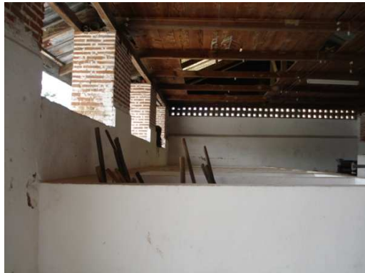
FOTOGRAFÍA No. 4 INTERIOR DE BENEFICIADO DE CAFÉ A. Aguilar Cabrera
