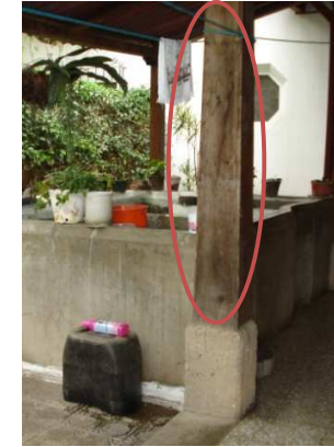
FOTOGRAFÍA No. 6 DETERIORO EN COLUMNAS DE MADERA POR SOLEAMIENTO Y LLUVIA A. Aguilar Cabrera
