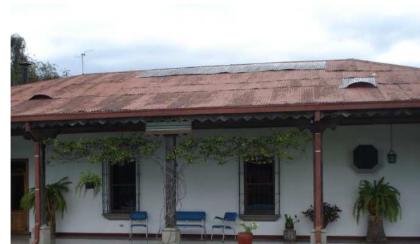
FOTOGRAFÍA No. 2 DETERIORO EN CUBIERTA DE LÁMINA, DEBIDO A LOS VIENTOS TANTO EN LA FOTOGRAFÍA 01 Y 02 A. Aguilar Cabrera
