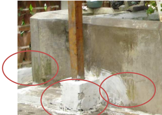
FOTOGRAFÍA No. 4 HUMEDAD EN PILA A. Aguilar Cabrera
