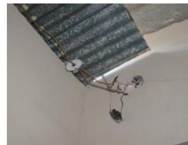
Imagen No.2: Estado actual de las instalaciones en edificio municipal, no poseen tuberías y están a intemperie.
