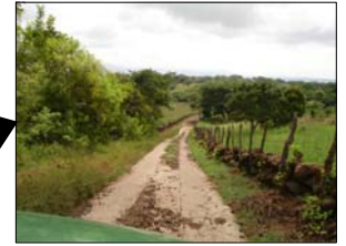
MILLA 59.00 APROXIMADAMENTE NO SE OBSERVAN RIELES NI DURMIENTES
