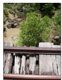
Tramo de la Vía Férra en muy mal estado
