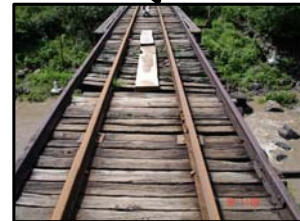
Estado actual de uno de los puentes de Anguiatú el cual se en mal estado.
