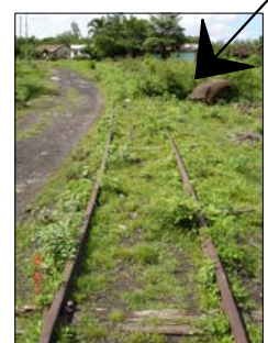
Tramo de la Vía Férra cubierto por maleza
