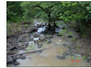
Vista de la Vía Tren en grave deterioro
