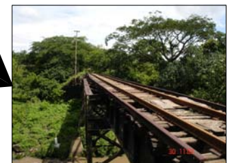
PUENTE EN MAL ESTADO PERO AUN TRANSITABLE
