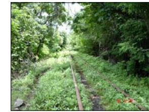
Rieles de la Vía del Tren cubierta de maleza y en constante deterioro
