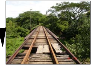
PUENTE DE LINEA FERREA EN EL LÍMITE TERRITORIAL DE NUESTRO PAÍS Y EL SALVADOR
