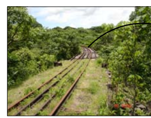
Los rieles de la Vía Férra ya no existen o están en un mal estado.
