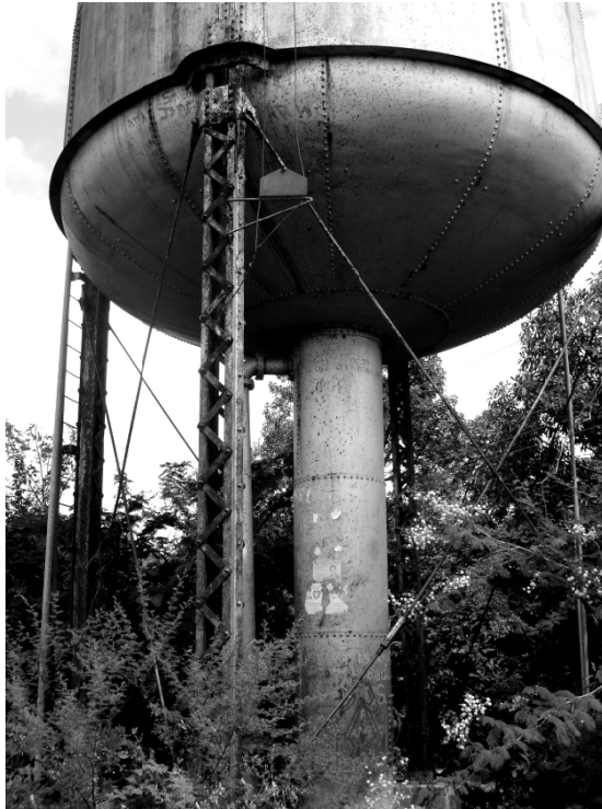
Ilustración No.8 Tanque elevado estación San Benito milla 64.5
