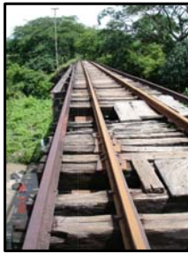
Situación actual de este puente deprorable.
