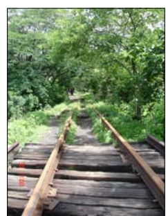
Tramo de la Vía Férra en estado depreciable
