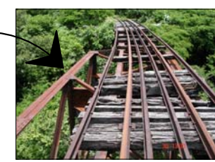
Puente Ferroviario en un estado de deterioro avanzado
