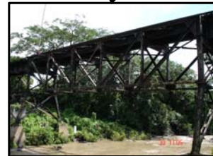
Estado actual de la estructura del puente el cual esta apunto de colapsar.
