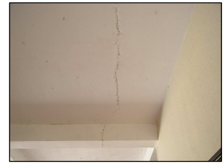
FOTOGRAFIA No. 99. FISURAS EN LOSA ELABORACIÓN PROPIA.
