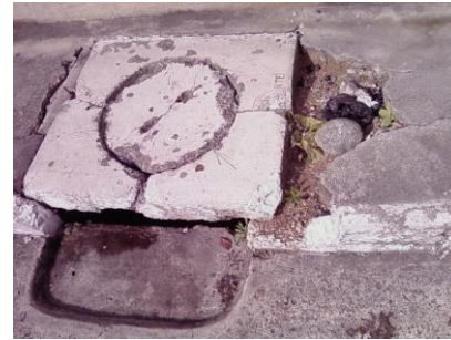
Fotografía 71. 6ª. Avenida entre 12 y 13 calles. El deterioro de las tapaderas provoca daños al usuario y a la banqueta. Autor: Mario Sánchez.
