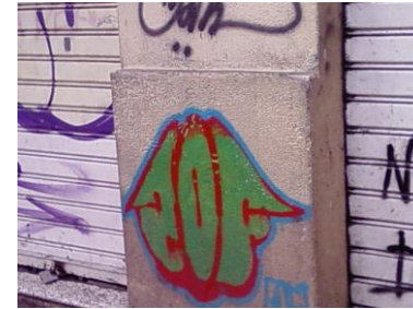
Fotografía 85. 6ª. Avenida entre 12 y 13 calles. Los muros con manchas provocadas deben de ser restaurados y pintados.
