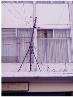
Fotografía 72. 6ª. Avenida entre 12 y 13 calles. El cableado eléctrico se encuentra adosado a los muros. Autor: Mario Sánchez.
