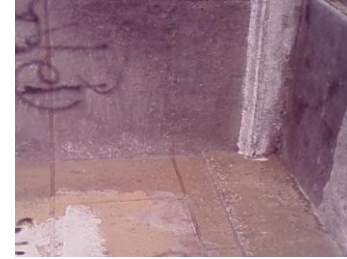
Fotografía 81. 6ª. Avenida entre 12 y 13 calles. La falta de servicios sanitarios, provoca que en las esquinas se realicen estos actos. Autor: Mario Sánchez.
