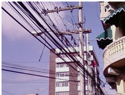
Fotografía 74. 6ª. Avenida entre 12 y 13 calles. La contaminación visual por el tendido eléctrico es evidente. Autor: Mario Sánchez.
