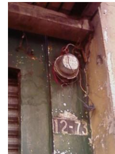
Fotografía 75. 6ª. Avenida entre 12 y 13 calles. Las edificaciones cuentan con transformadores en lugares no aptos. Autor: Mario Sánchez.
