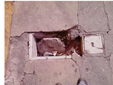
Fotografía 55, 6ª. Avenida entre 12 y 13 calles. Uno de los obstáculos, la falta de tapaderas de agua.
