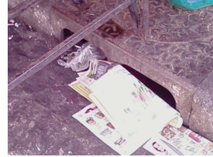
Fotografía 69. 6ª. Avenida entre 12 y 13 calles. La constante contaminación provoca daño en los tragantes. Autor: Mario Sánchez.
