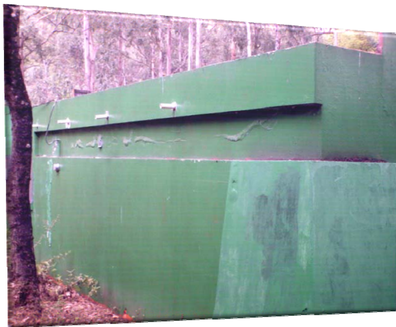
Imagen No. 2 Deterioro del edificio actual.
